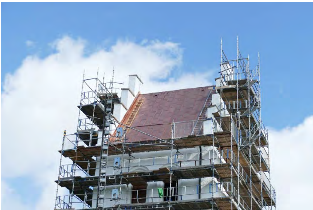
Det nya koppertaket är på plats. Det mindre plåtformatet gör hela taktäckningen stabilare och mindre känsligt för bl.a. stark vind.
