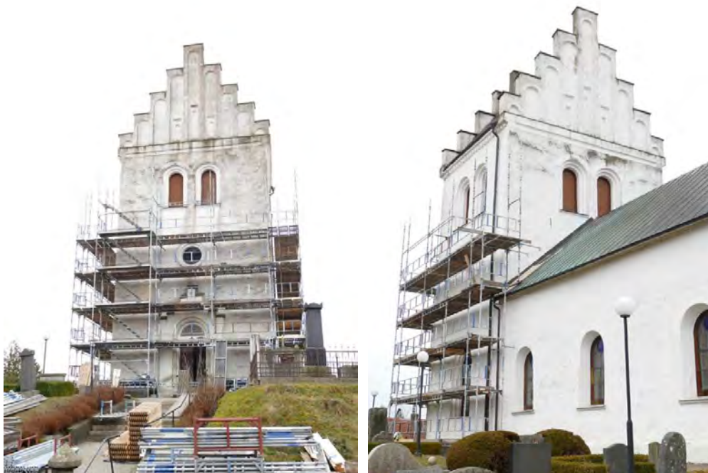
Västra Torups kyrka inför renoveringen. Vid första byggmötet höll ställningarna på att resas. Observera den omfattande svärtningen på framförallt tornets västra fasad. De två övre bilderna på denna sida visar skador på portalomfattningen; mekaniska skador liksom svärtning, putsbortfall och sandande puts.
