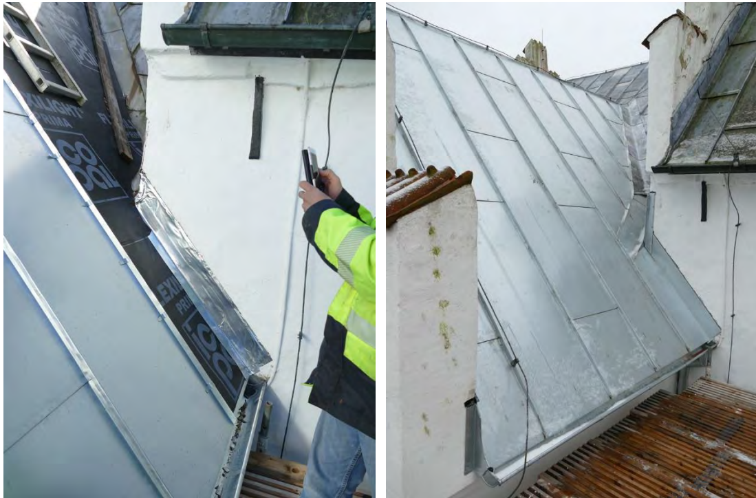
Sakristians västra takfall. Notera hur regndalen utförts och hur kortakets blyplåt går ner över sakristians plåt.
