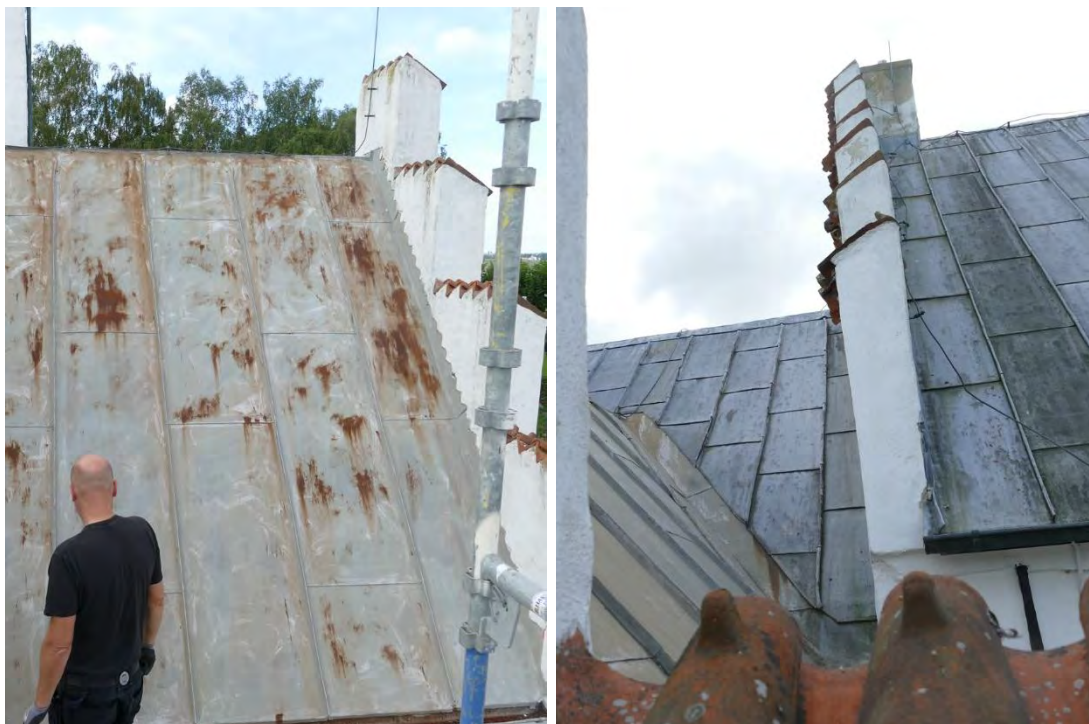
Sakristians tak, före bytet. Notera den trappstegsformade anslutningen till trappgaveln på bild t. v.
