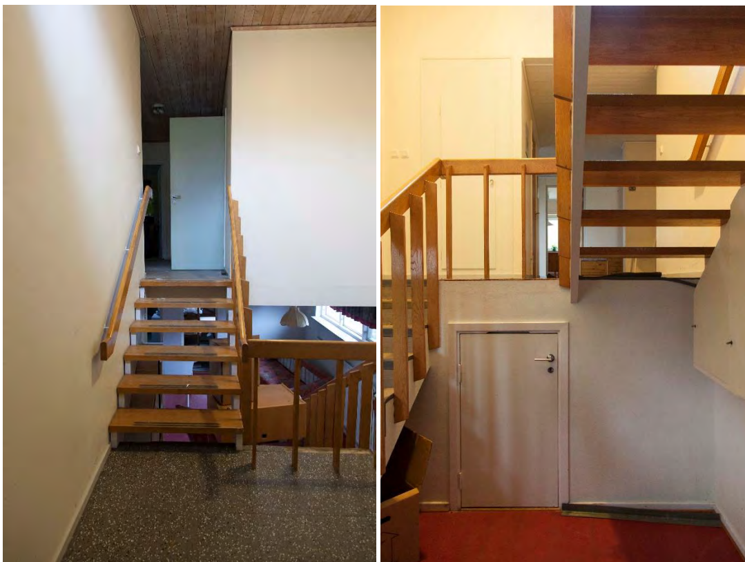
Till vänster hallen med halvtrappor till sovrumssavdelningen respektive till källarplanet. Avsaknad av sättsteg möjliggjorde kommunikation mellan de olika våningsplanen. Till höger källarplanets hall som i flera fall verkar ha använts som hobbyrum. Bakom den mindre dörren ryms teknisk installation.
