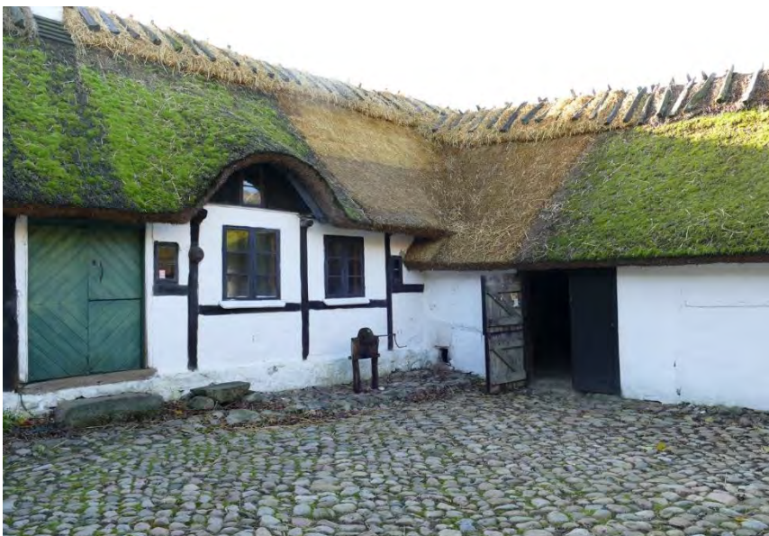
Den omlagda svingeln ryggades om med ny halm. Samtidigt kompletterades ryggningen fram till bostadshusets skorsten med ny halm. Oktober 2019.
