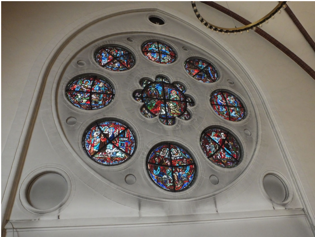
Rosettfönster i norra korsarmen inför renoveringen, april 2018. Värmerören som satt i nedre delen av nischen är borttagna men tydliga smuts-spår visar var de suttit.
