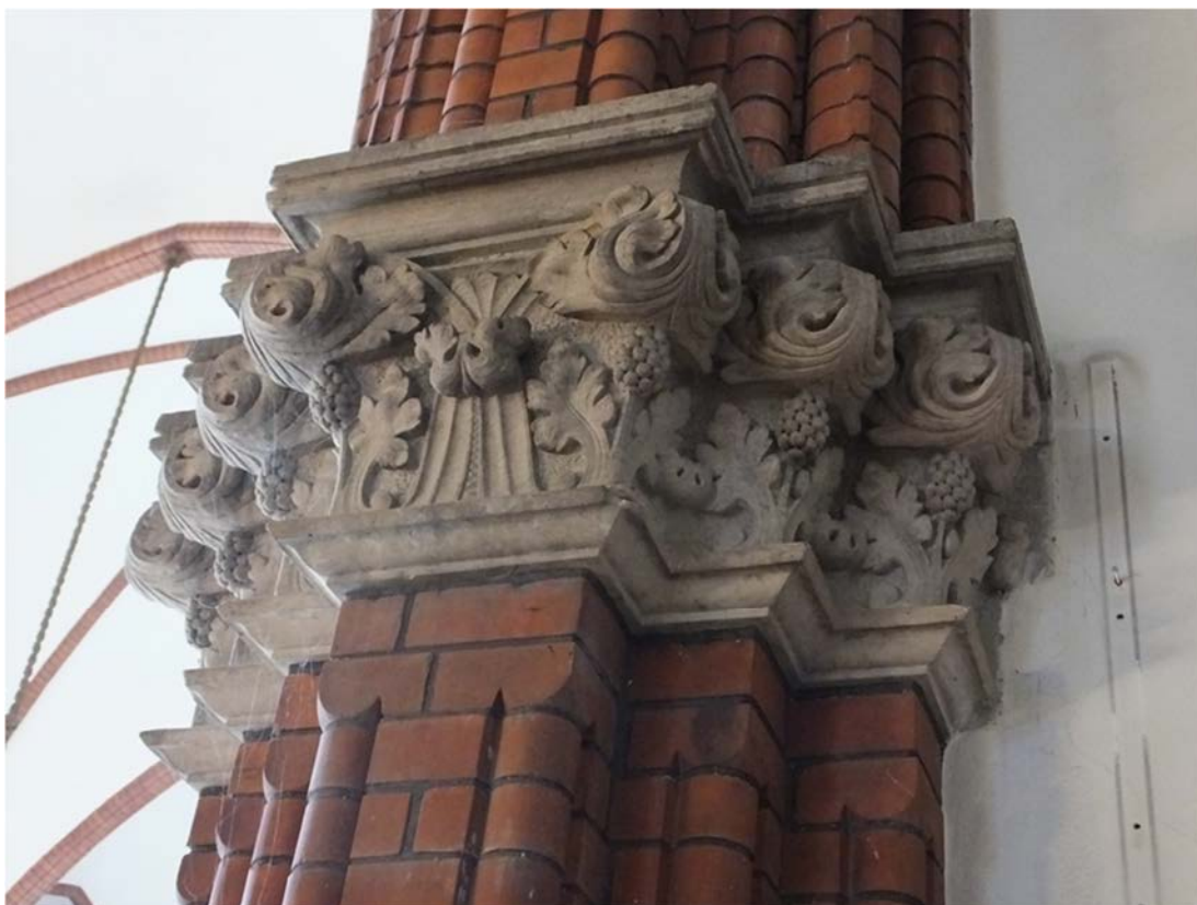
Kapitel i gjuten och ythuggen betong inbäddade i ett tunt lager av damm och spindelväv. Inför rengöring i juni 2018.
