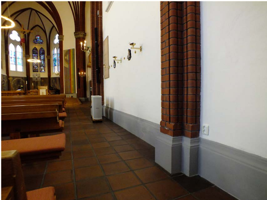
På sockel utmed södra väggen har saltutfällningar redan börjat synas på putsen. Återkommande besiktning och underhåll kommer att vara nödvändigt. Det är viktigt att sockeln lagas med genomsläpplig puts och färg. Risk finns annars att fukten och därmed saltet vandrar längre upp i murverket och orsaker skador i muren och på ytor som är svårare att komma åt.
