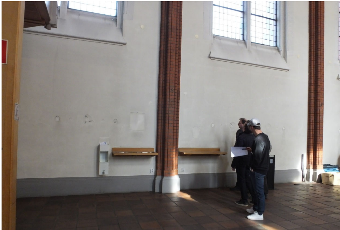
Norra väggpartiet närmast orgelläktaren. Armaturer och tavlor på väggarna samt värmerören under fönsterglasen har demonterats och lämnat efter sig tydliga smutsspår. På denna sida var sockeln i bättre skick än på södra sidan. April 2018.
