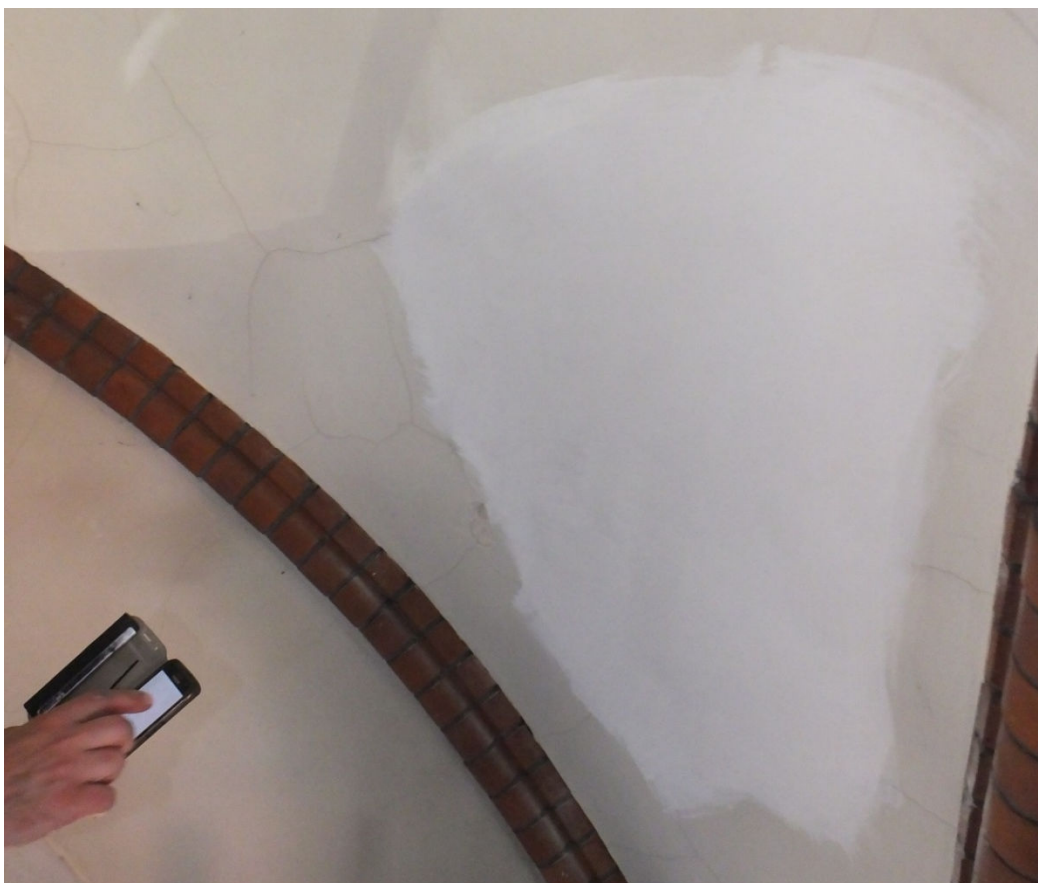
Putsen på väggarna var generellt i gott skick. Längst upp i valven fanns ett nätverk av små, ytliga sprickor som försvann efter rengöring av ytan (den vita ytan). Juni 2018.
