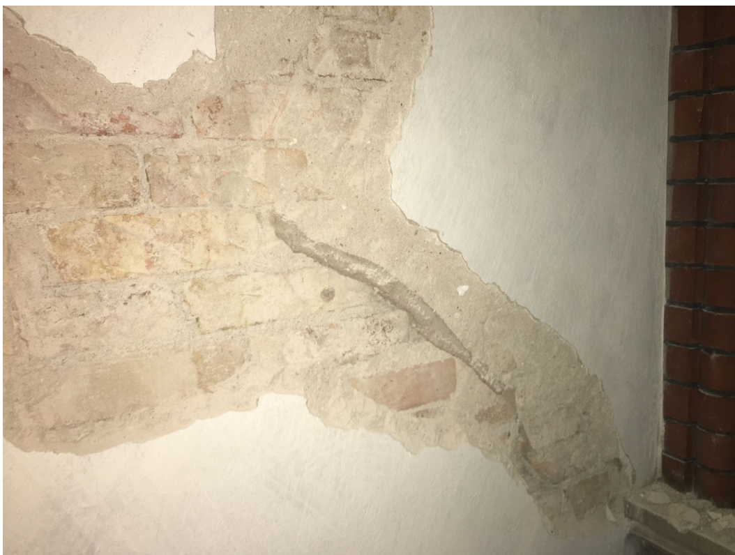
På enstaka ställen fanns större sprickor som krävde mer omfattande putslagning. Denna spricka med en äldre lagning finns i södra korsarmen på väggen mot öster. Juli 2018.
