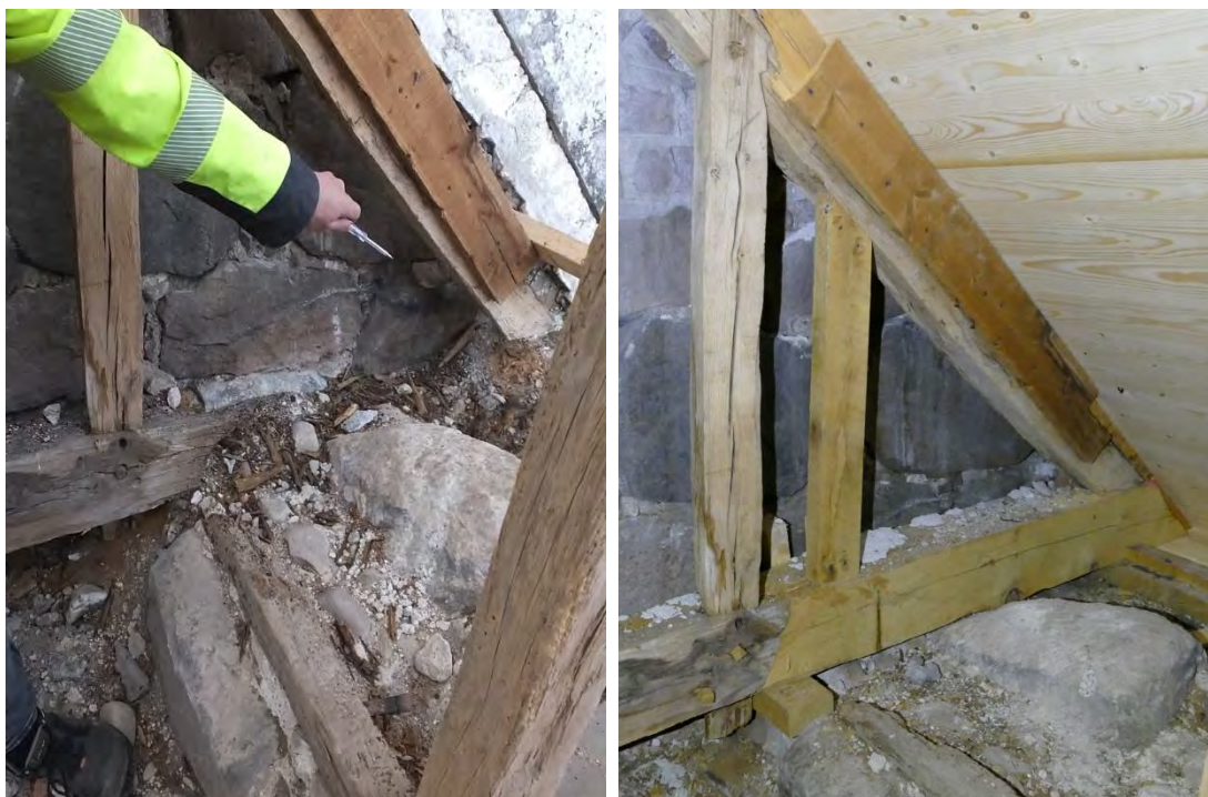
Korets västra gavel, mot norra sidan. Bjälken lagades i med nytt timmer som halvades och dymlades fast. En ny stötta tillkom också.
