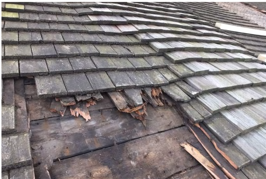
Långhustaketets spån och dess underbrädning hade tagit skada av kreosotbehandlingen. T h ses en senare lagning.
