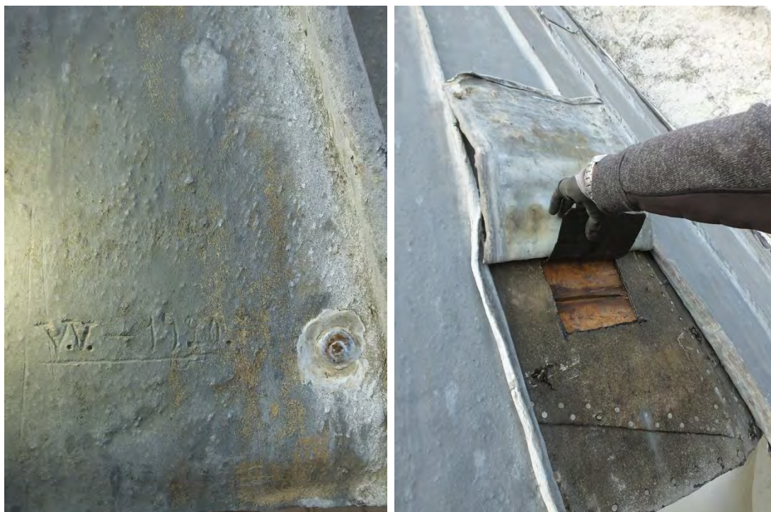
T v: Inristningen "V.V. - 1920." tyder på att taket lagts om helt eller delvis detta år. T h: Mellan papp och underbrädning fanns spår av svampmycel vilket tyder på att undertaket varit för tätt.
