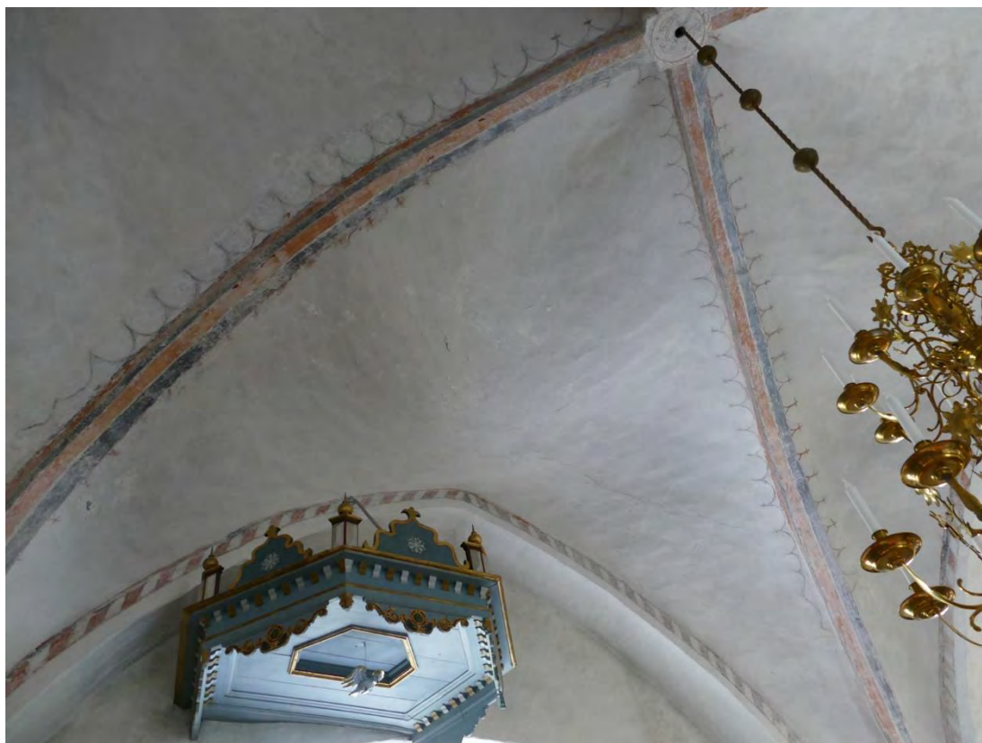
Sprickbildningen som kan ha orsakats av takläckage syns främst i de södra valven i långhuset.
