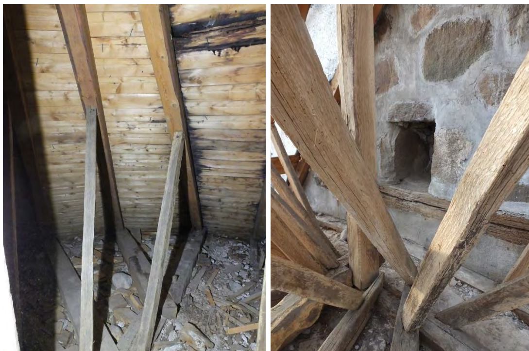
Läckage genom papp och brädor var synligt på en del ställen inifrån absidvinden. T. h. ses en del av de fint buggna stöttorna som fått patina med tiden. En rötskadad bindbjälke utan funktion är inmurad i gaveln.
