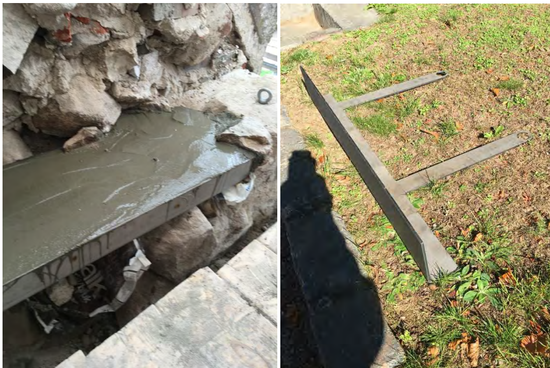
Balken med betonggjutning som murades in i den östra kornväggen, se även föregående sida. Foton: Niclas Hansson, Danewids Ingenjörbyrå.
