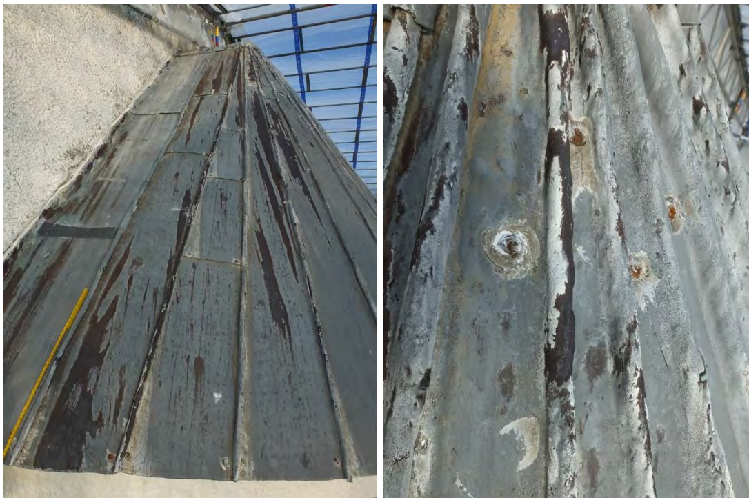
T v: Absidtakets södra sida. Den vänstra skivan var valsad och sentida medan de övriga var gjutna och äldre. T h: Detalj av taket visar en del av de felaktiga infästningarna med numera sönderrostade nitar och lödning kring hålen.
