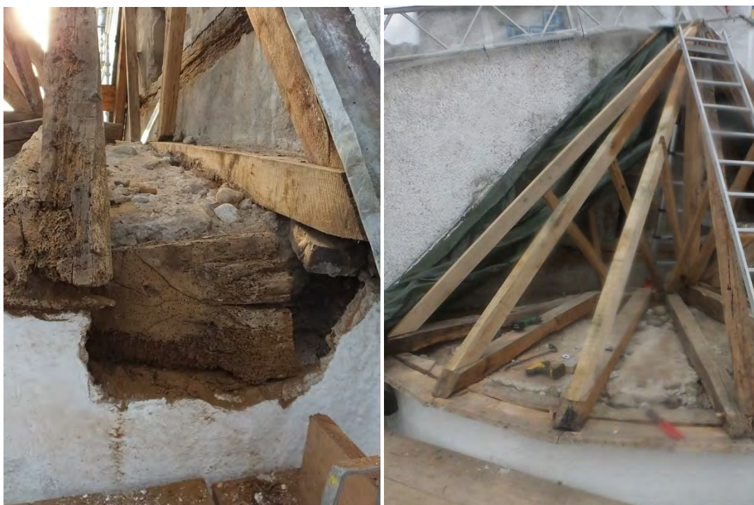
T. v: Remstycket närmast koret vid den norra sidan var i dåligt skick och ersattes. Enligt dendrodateringen var denna del fälld någon gång kring 1100-talets mitt och bedöms höra samman med den övriga takstolen från 1160-talet. T. h: Tre av sparrarna på den södra sidan byttes, ytterligare några laskades i med nytt virke i den nedre delen.
