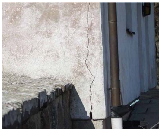
Personalbyggnaden är i behov av fasadrenovering.
