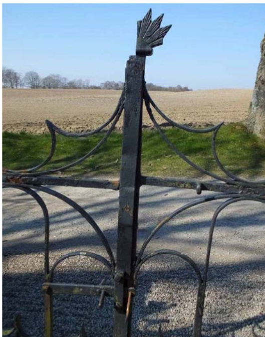
Rostigt järnstaket med trasiga dekorationer.
