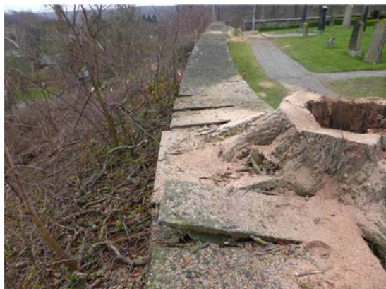
Skador i östra muren orsakade av trädets rötter.
