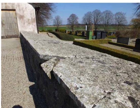
Trasig sten i antäckningen på muren vid personalbyggnaden.
