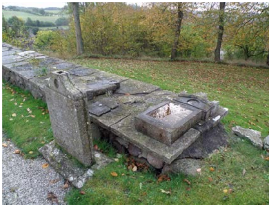
Muren på gamla kyrkogården är i behov av renovering.
