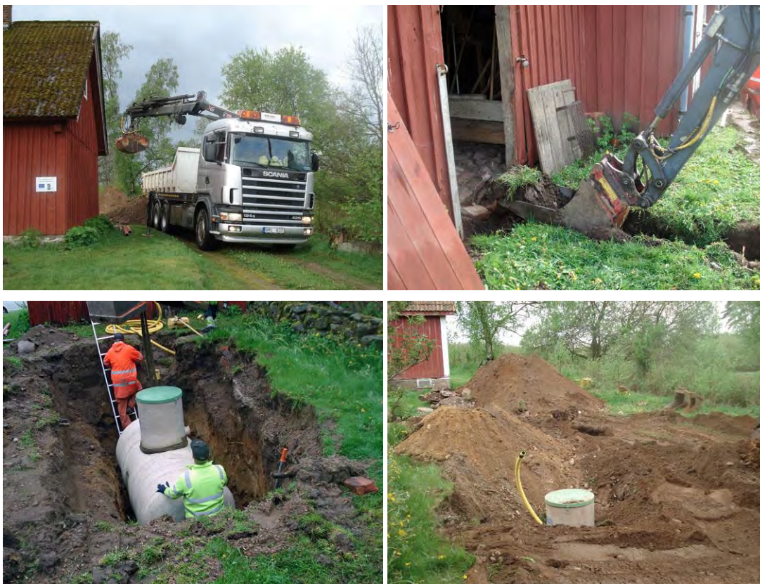
Toalettbygget förde med sig omfattande grävningsarbete för avlopptanken. Foton: Torgel Hagelin, ansvarig för Byggdelen i projektet.
