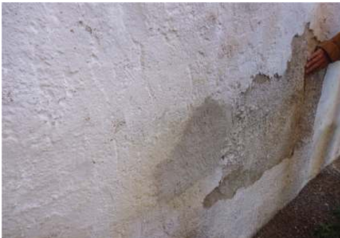
Fig. 6. Till höger exempel på puts-skada, vänster där om en nylagd skada.
