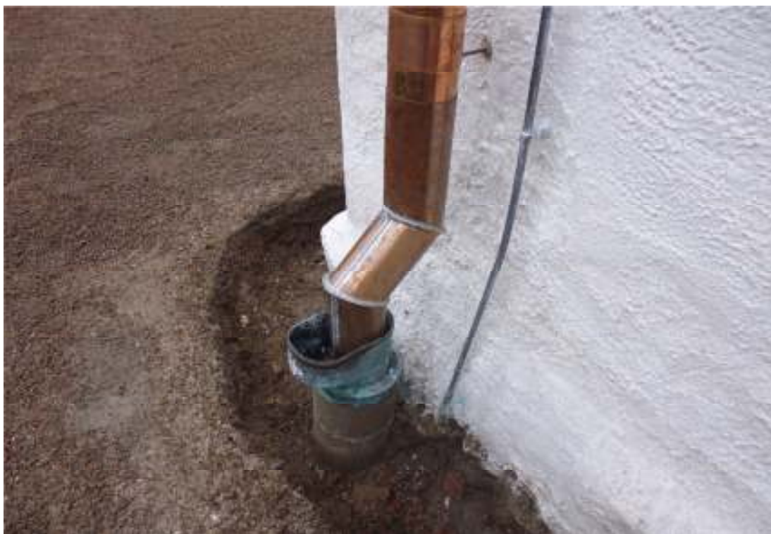
Fig. 12. Nytt stuprör med skarpa vinklar.
