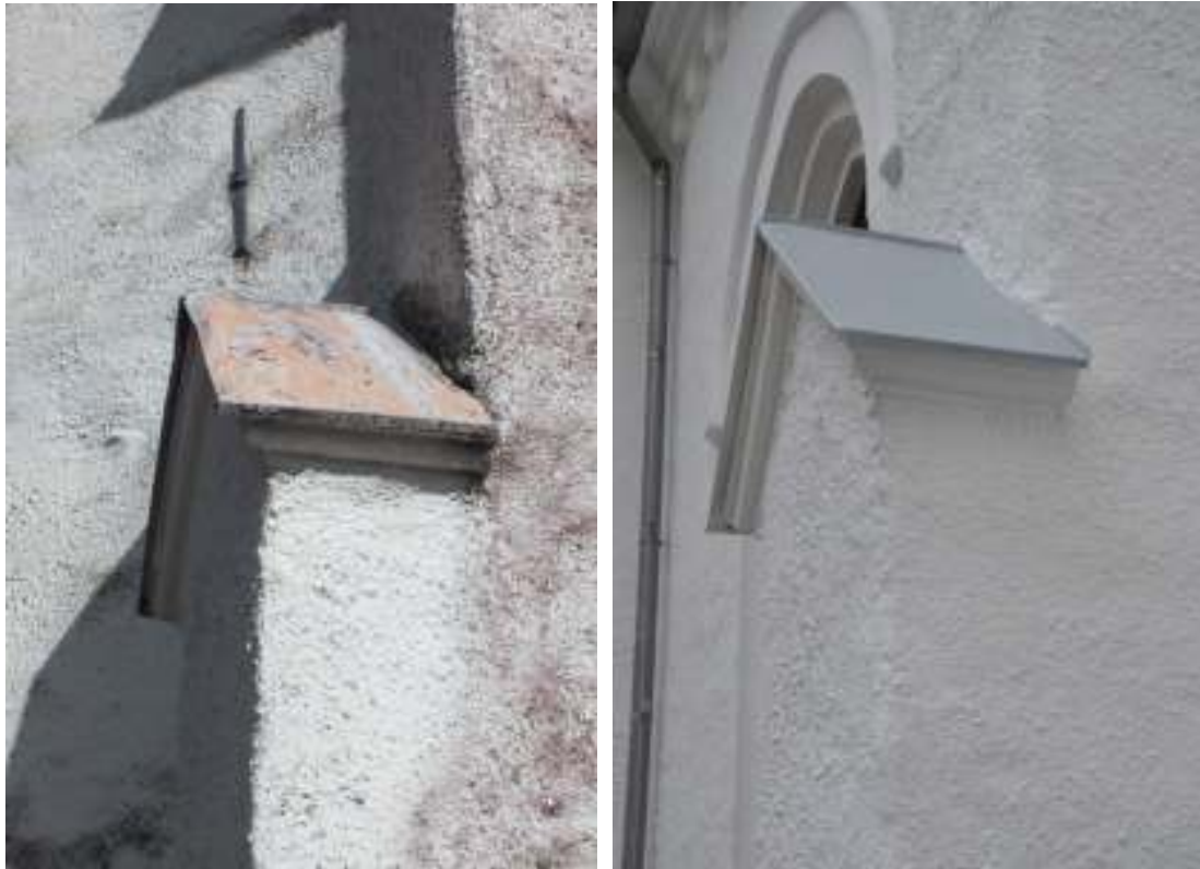
Avtäckningarna på kyrkans stränpelare har skrapats ner och avfärgats med grå linoljafärg.
