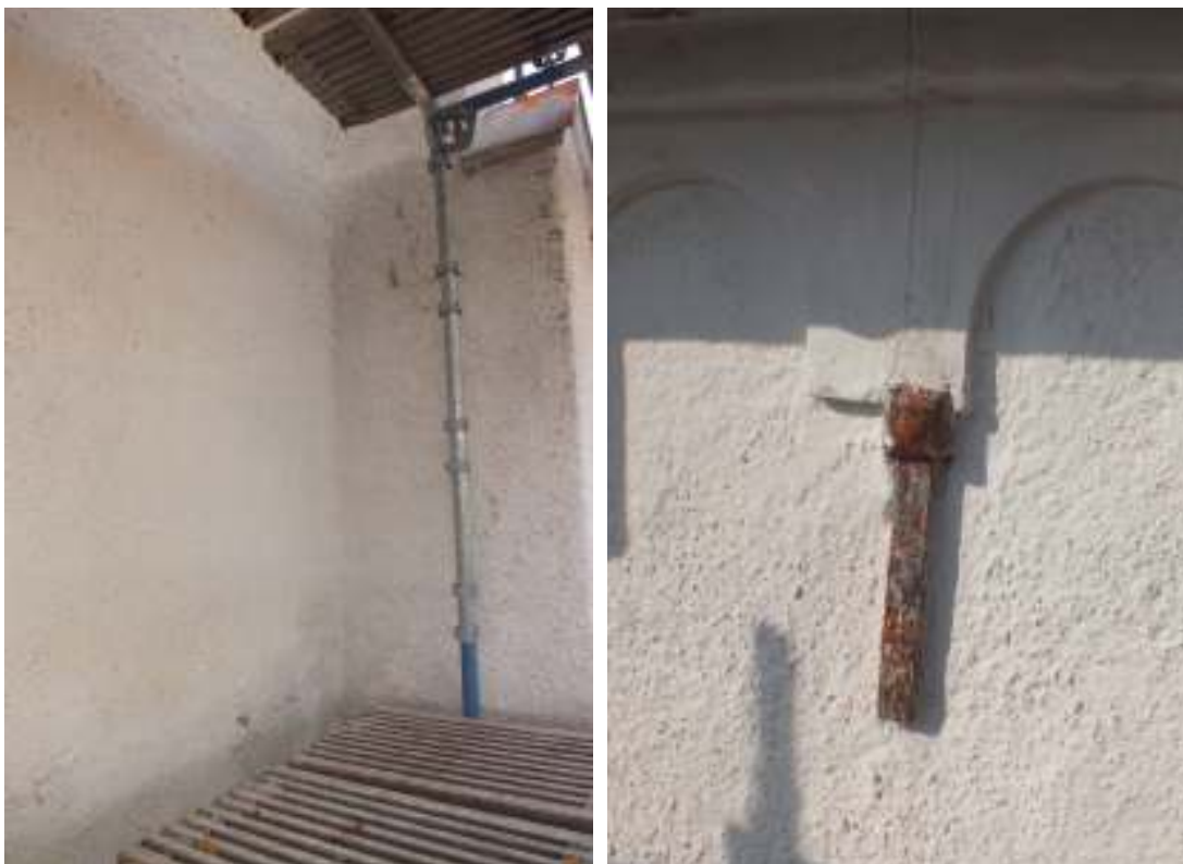
T.v: Fasadens bättringsmålning med silikatfärg framkom tydligt efter tvätt. T.h: Tunt överputsat ankarjärn i tornets fris.
