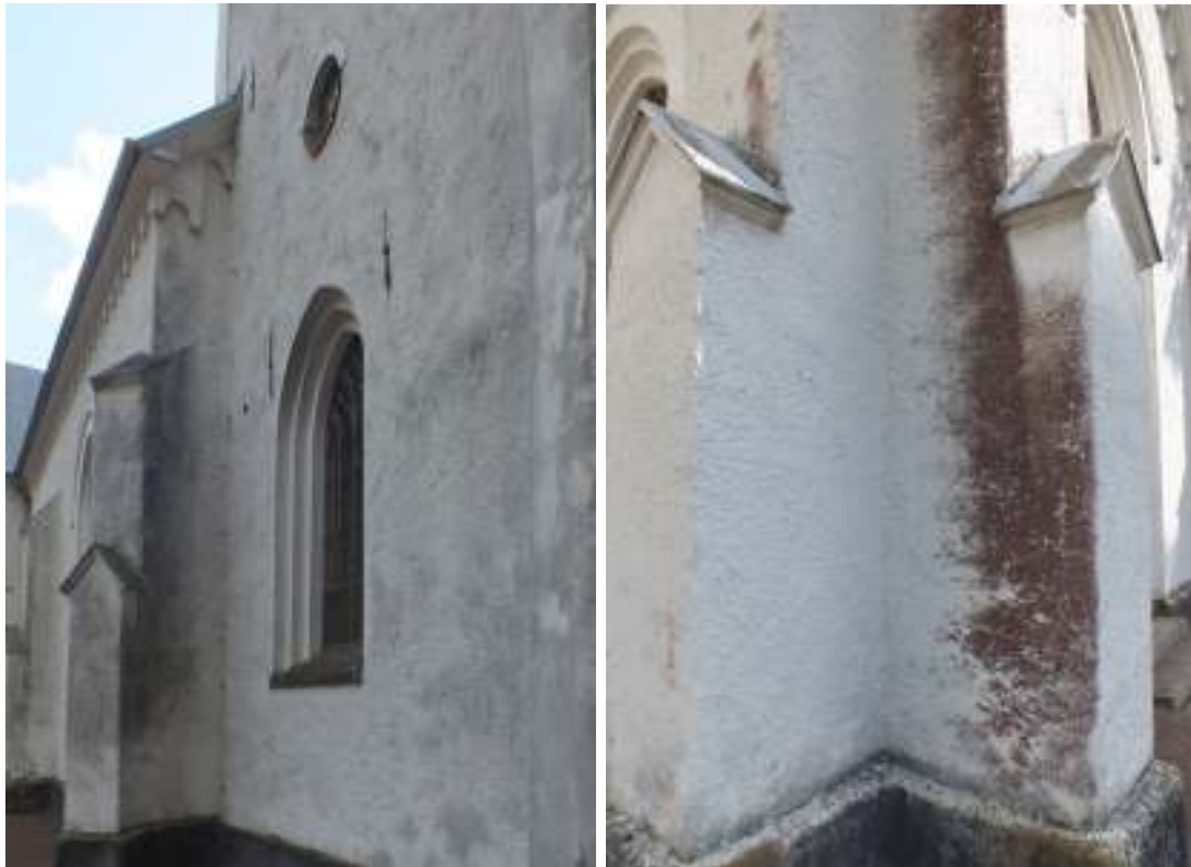
T.v: Kyrkans norra långhus- och tornfasad före renoveringen. T.h: rödalger på vid strävpelarna på den södra korsarmen.
