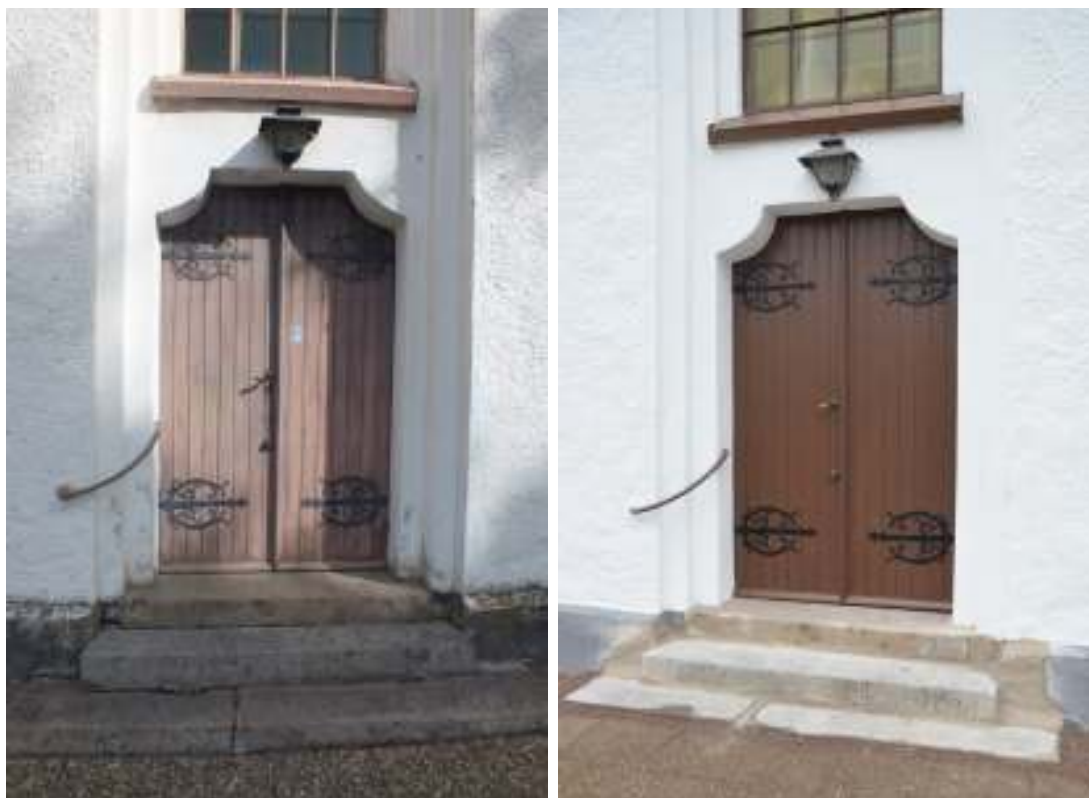
Den södra korsarmens port avfärgades och trappan lades om med nytt bruk.
