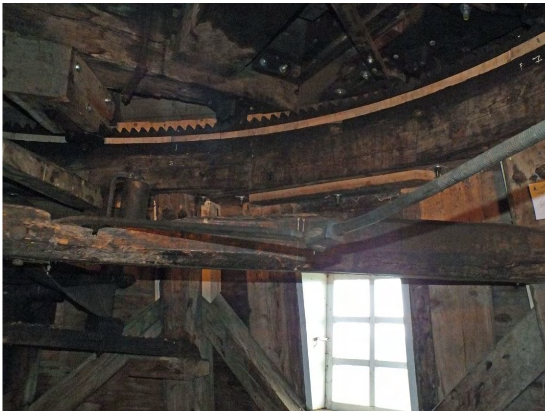
Den nya lejden har kommit på plats i hättan och delar av kuggkransen (rälsen) som var sprucken har ersatts av bel dito.
