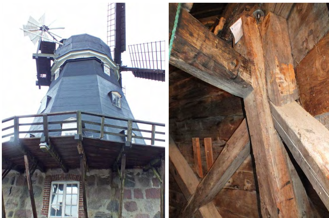
Till vänster syns möllan och den tillfälliga ställning som hängt på bättan, för att kunna göra exteriöra åtgärder i samband med renoveringen. Till höger bild inifrån bättan, där en ståndare försetts med en papperslapp som markerar differensen för bockhuvudplankan (även kallad bockryggsplankan), det vill säga att konstruktionen inte är i våg.
