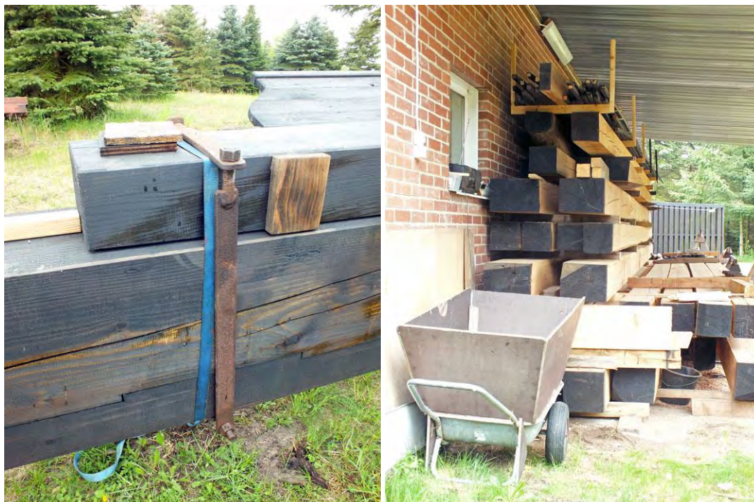
Till vänster vingbalk och vingträn sammanfogade och säkrade med hjälp av de återvända järnen. Till höger virke på tork intill snickeriet Ingemars Bygg.
