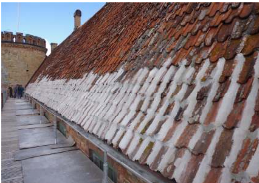
Västra slottslängan, västra takfallet. Skällning av takpanneraderna närmast takfoten.
