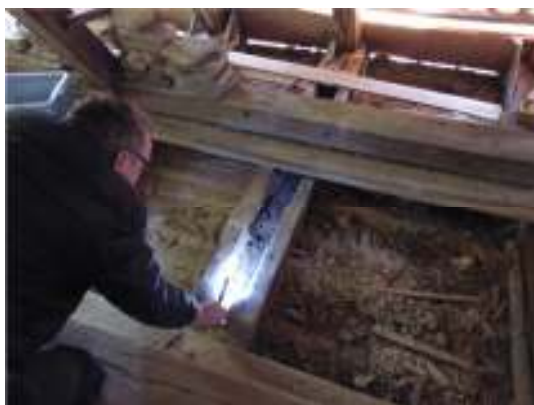
Den östra insektsangripna bindbjälken.
