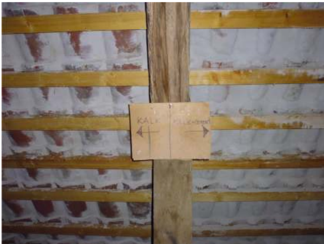
Västra slottslängan, östra takfallet. Understrykningens brukstyp finns angiven på skylten. Norr är till vänster.
