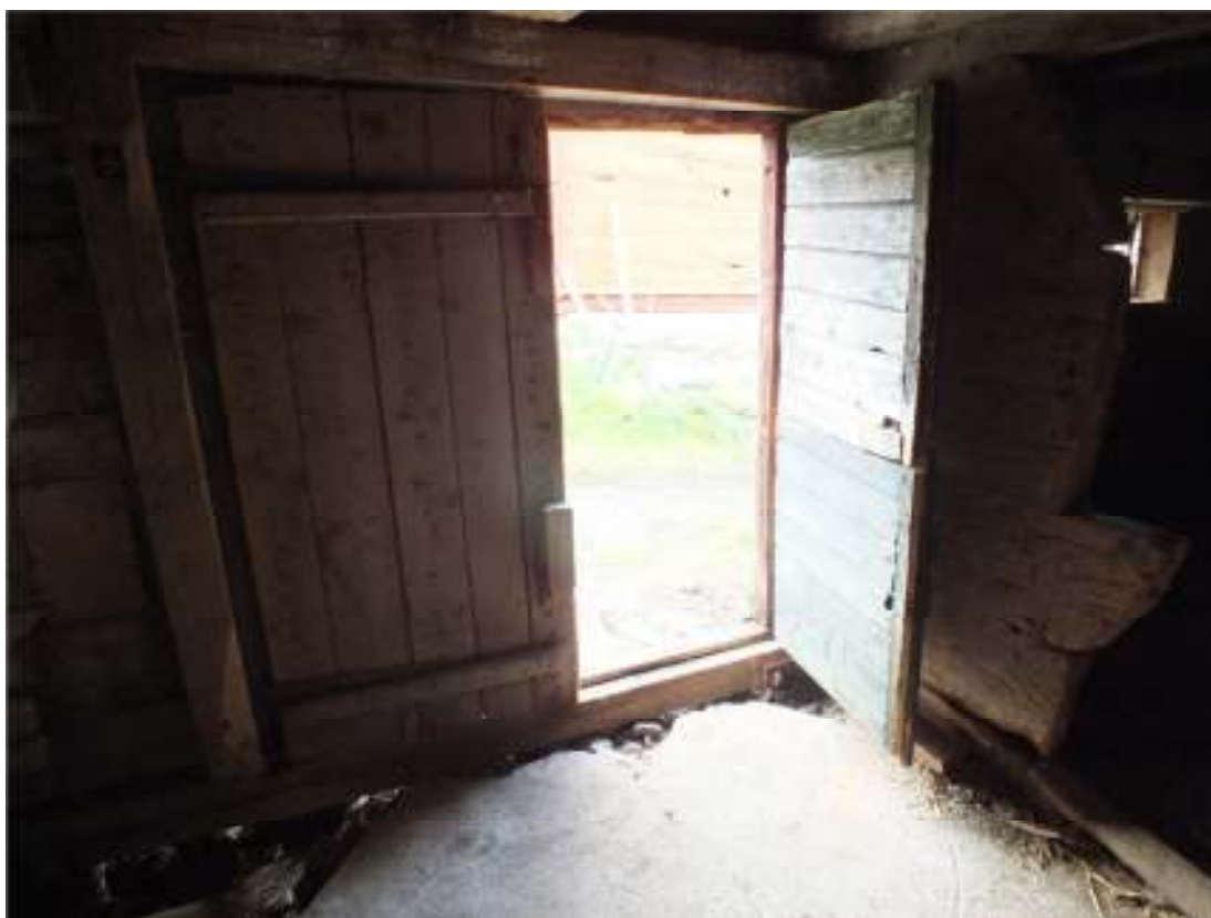
Dörröppningen på den södra långsidan sedan arbetena har avslutats. Det gamla fotträet var praktiskt taget taget bort och i och med att den nya ekbiten har kommit på plats har kindstolparna på nytt ett fast underlag. Dörrbladen har sågats av i nederkant och fotträet har tagits ur för att återställa funktionen.
