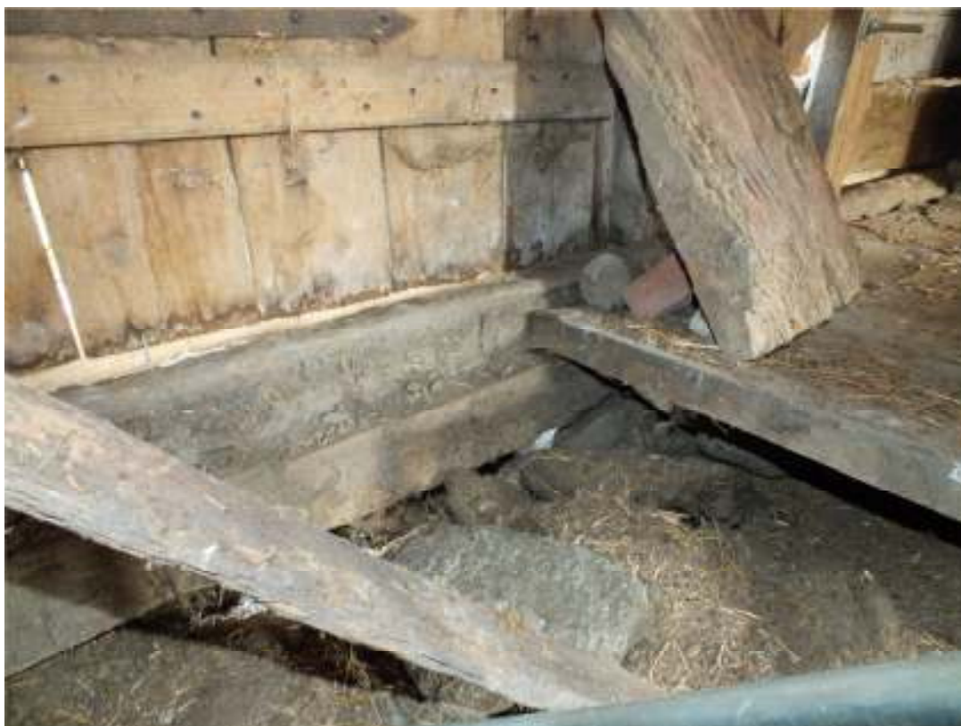
Vid byte av timmerstommens fotträ åt norr upptäcktes ytterligare ett fotträ innanför.
