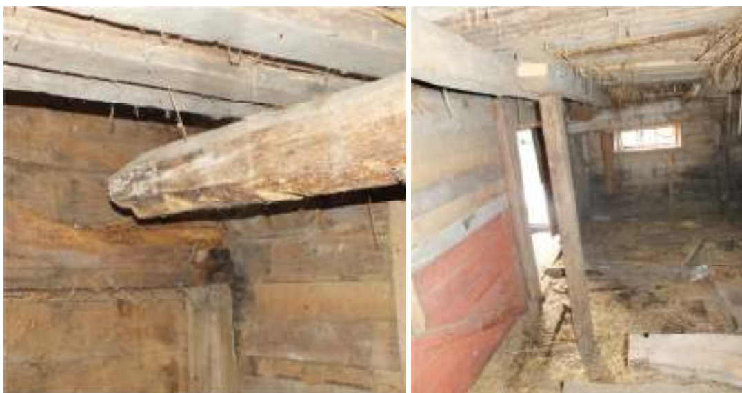
Bindbjälken, placerad öster om byggnadens mellanvägg, hade så pass omfattande skador att den inte längre vilade mot sitt underlag i norr. Befintlig bindbjälke har kapats och en ny återanvänd bit har lagts i dess ställe samt bultats fast i resterande del. Sammanfogningen med bultar ses på den högra bilden ovan.
