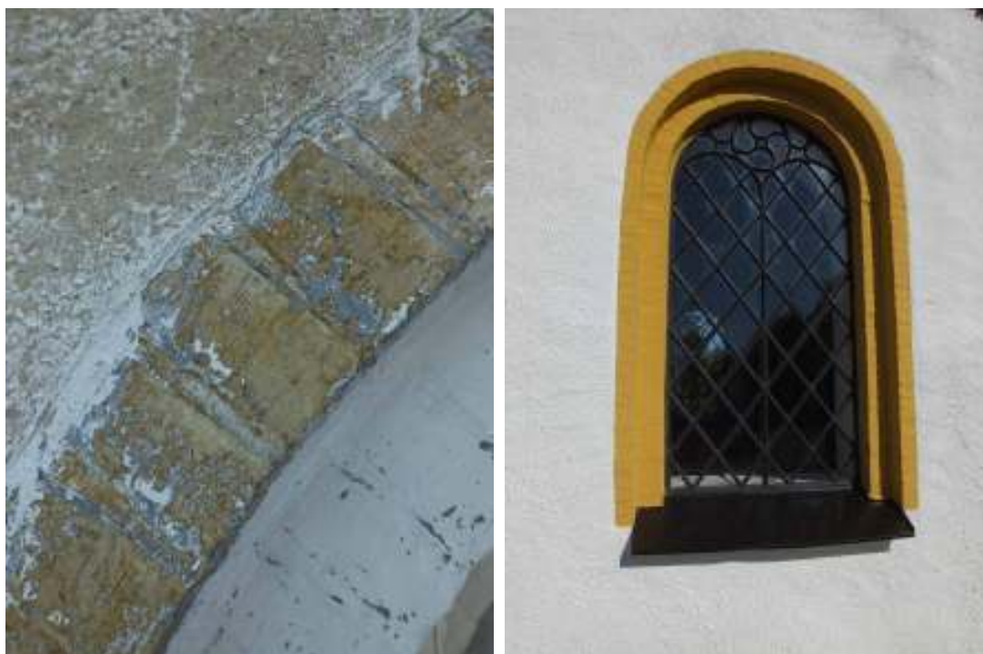
Till vänster: Äldre färgspår på fönsteromfattningar syns under vit kalkning. Underst syns en ockragul färg och därefter har omfattningarna varit gråmålade. Till höger syns fönsteröppning efter utförd ommålning.
