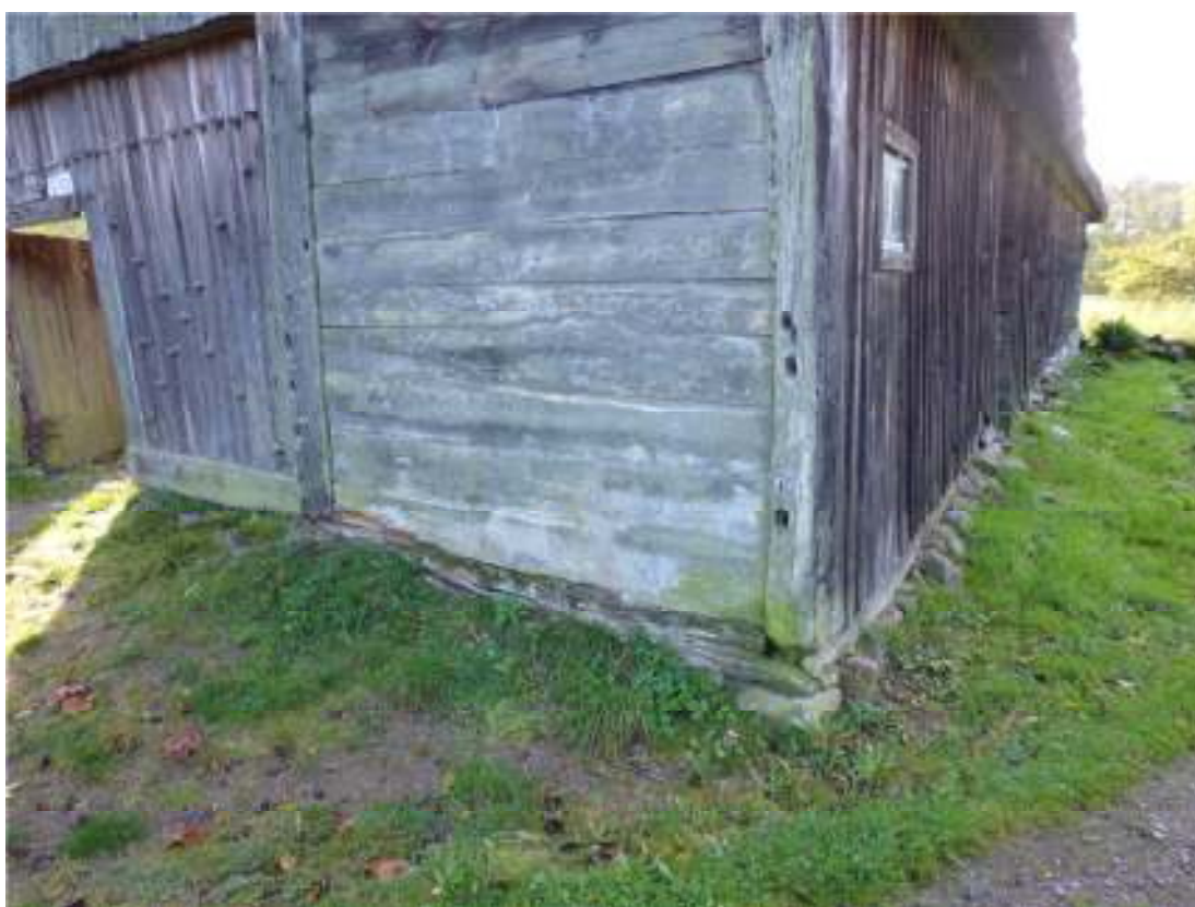
Fig. 4. Västra längans norra gavel. Fotträet som är i behov av byte.
