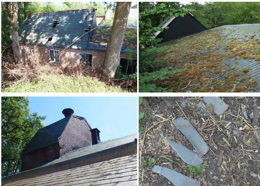
Överst till vänster syns trämöllans skadade skiffertak och till vänster den del som tidigare försetts med skalskydd i form av ett plåttak. Under till vänster syns baksidan av lim- och hartstornet samt del av holländeriets tak, samtliga med takfall täckta av skiffer. Till höger splittrade skifferplattor, som fallit eller kasserats i samband med renoveringen.
