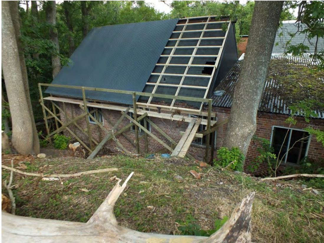
Trämöllans skiffertak kräver omfattande åtgärder. De rymdes inte inom befintligt bidrag men för att inte förvärpa skadebilden lades ett skyddande plättak ovanpå. Metoden är densamma som då den lägre byggnaden, till böger, fick ett skalskydd för snart tio år sedan.
