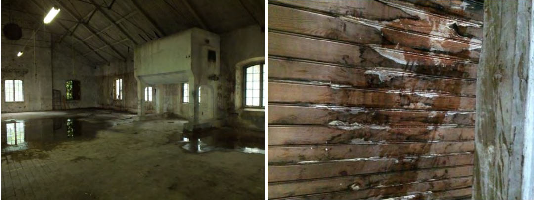
Holländeriets ovanvåning uppvisade omfattande läckage innan renoveringen påbörjades. När arbetet pågätt en tid upptäcktes även ett läckage som resulterat i svampangrepp uppe i hartstornets innertak. (Fotot på svampangreppet är taget av Thomas Gudmundson, T. Gudmundssons Bygg.)
