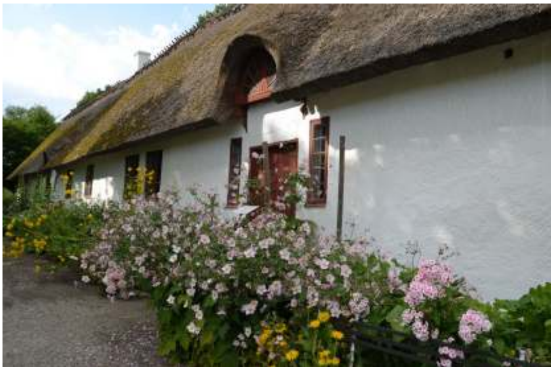
Burlövs prästgårds södra fasad efter att fasaden putslagats och anfärgats, slutet av juli 2014.
