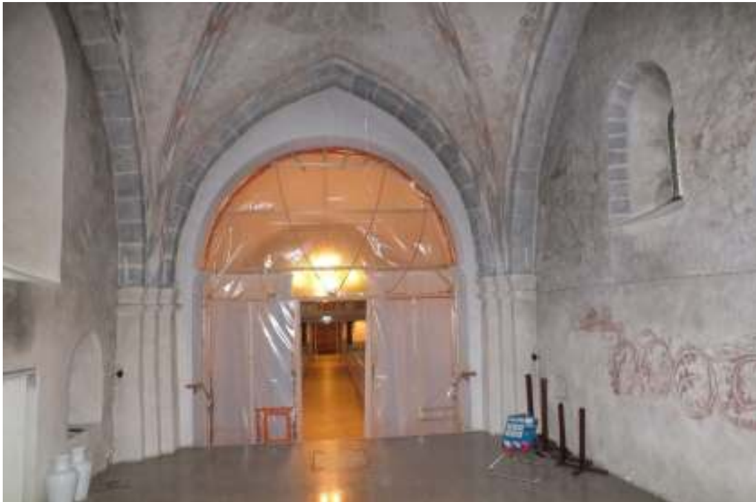
Bilden ovan visar avskärningen från resterande kyrkorum inför konserveringen av kalkmålningarna i kor och absid, sett inifrån koret ut mot långhuset. På bilden syns en spricka som löper genom triumfbågen samt ytsmutsen på putsen.
