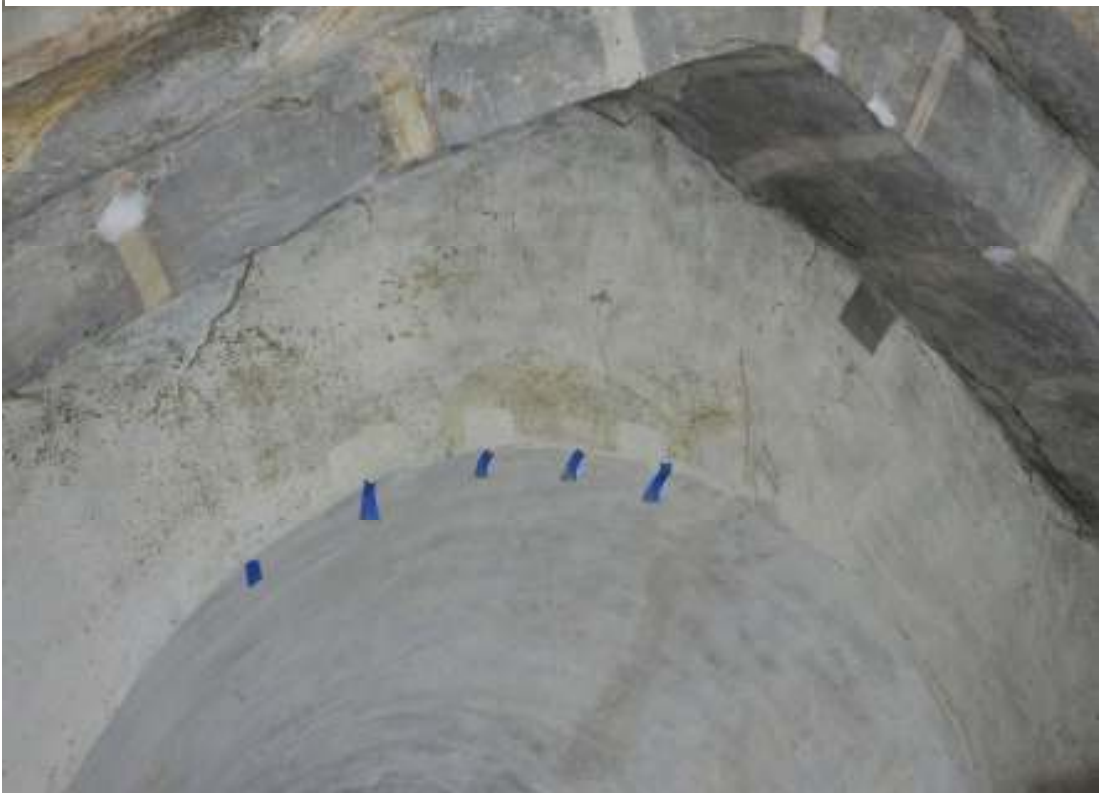
Inför konserveringen gjordes ett antal rengöringsprover. Bilden visar ett sådant prov på gul missfärgning och mögelspridning i koret.
