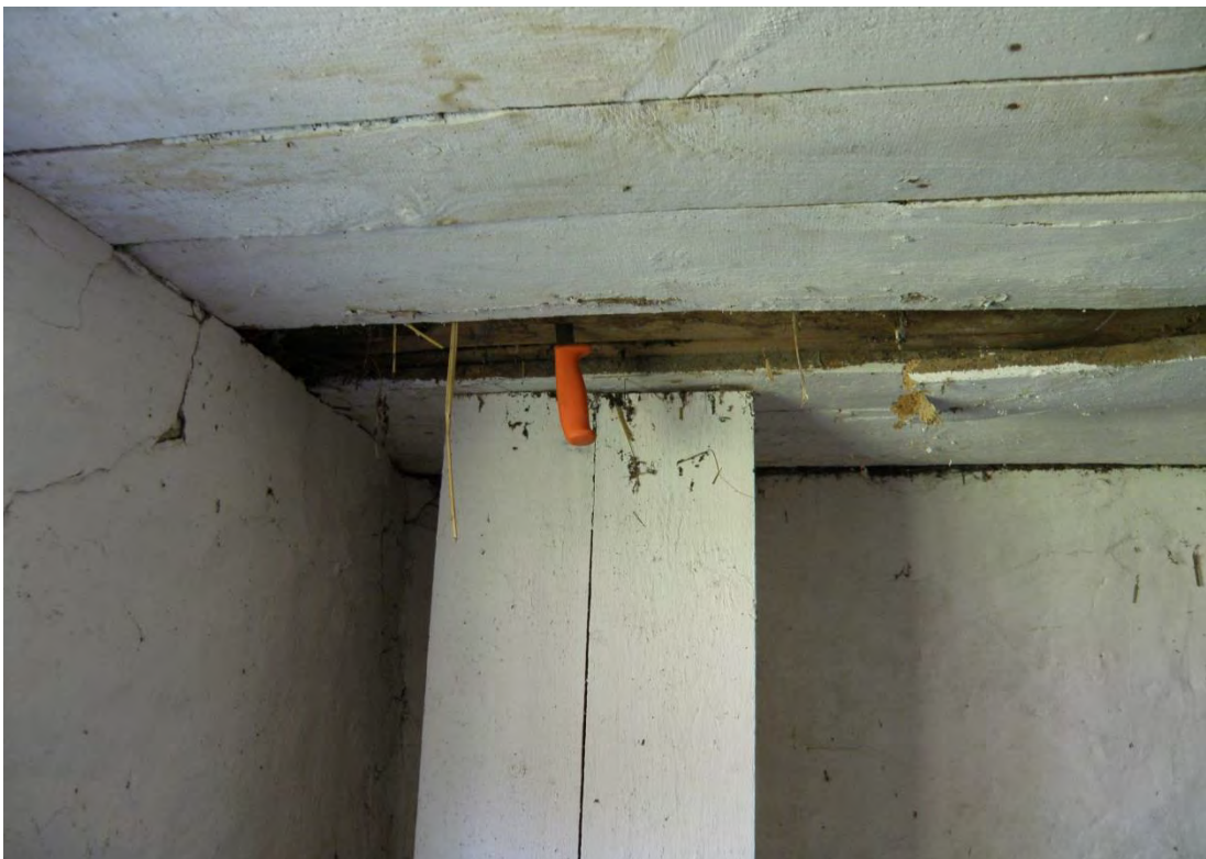
Fig. 7. Rötskada i kostallets tak, nordöstra delen mot gaveln.
