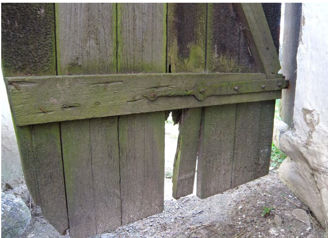
Fig. 11. Rötskadat dörrblad i gattet mellan boningsdelen och östra länkan.
