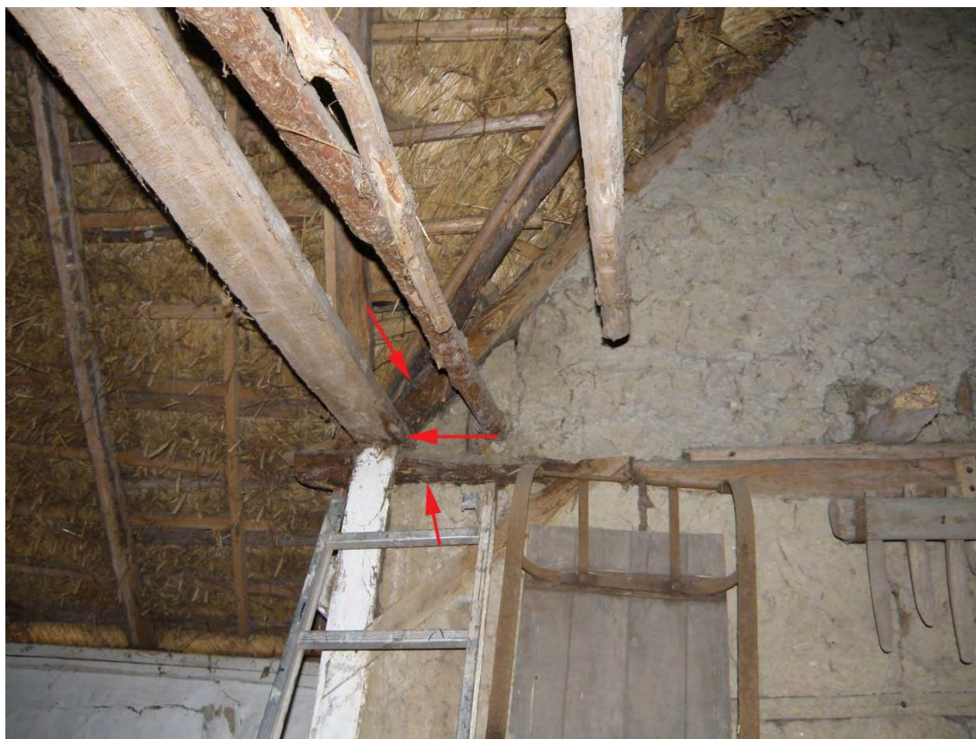
Fig. 3. Pilarna visar rötskadad sparre, bindbjälke och lejd på boningshusets nordvästra hörn.
