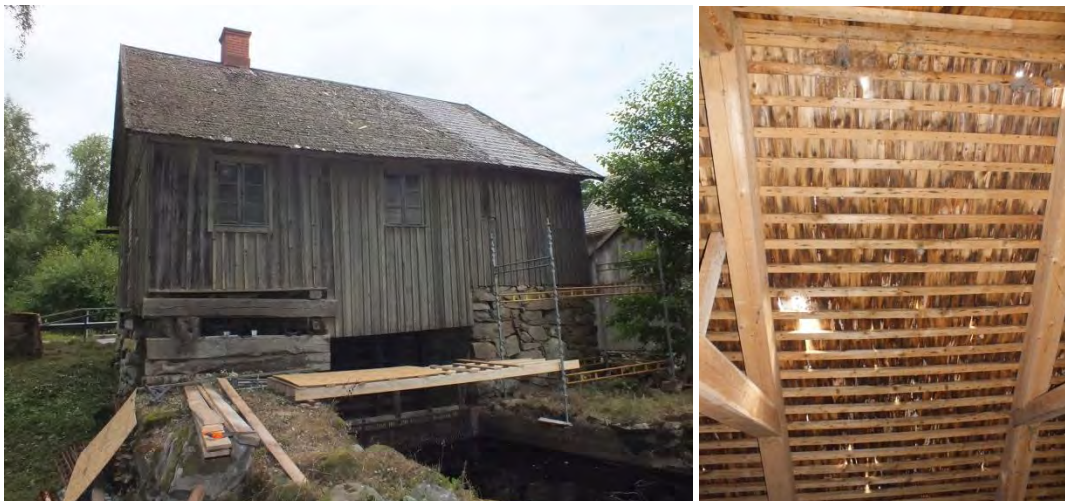
Till vänster ses det sydöstra takfallet innan arbetena påbörjades, notera lagningen på den högra delen av takfallet. Till höger bild inifrån byggnaden som visar en tunn spåntäckning med hål i.
