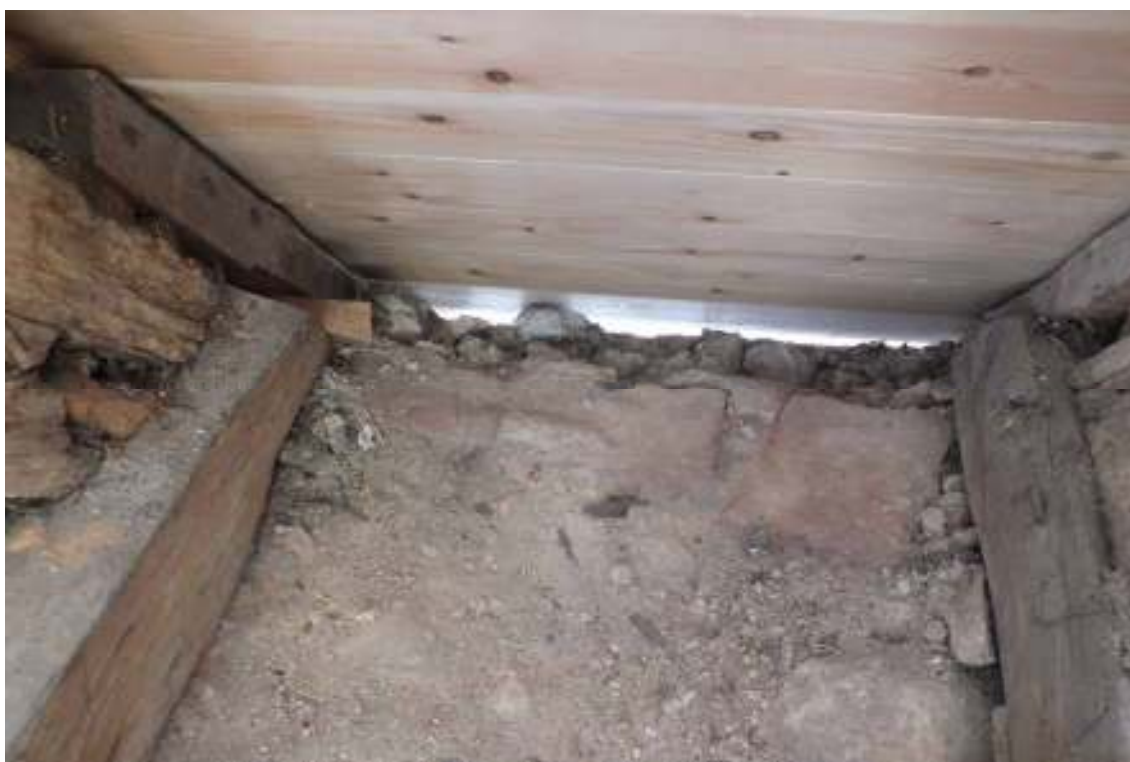
Södra murkrönet mellan 7:de och 8:de takstolen. Utmed takfoten har tegel murats på murkrönet. Inget synligt remstycke finns.
