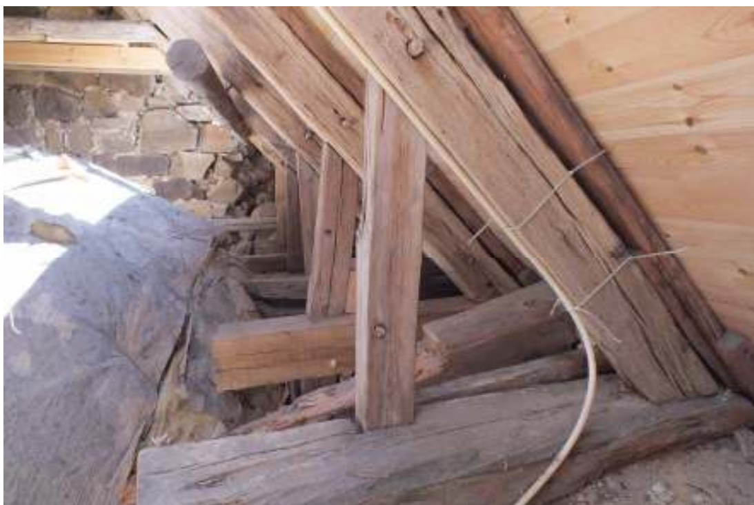
Takstol 6, södra takfallet, sett från väster. Bakom takstol 6 syns takstol 5 som åtgärdades med ny sticbjälke av ek.
