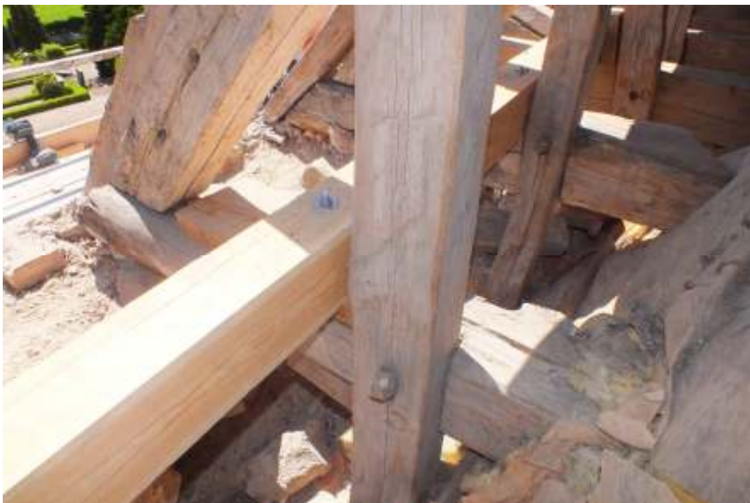
Förstärkning av takstolarna gjordes på södra sidan genom en bjälke ovanpå stickebjälkarna som skruvades och bultades till stickebjälkarna.
