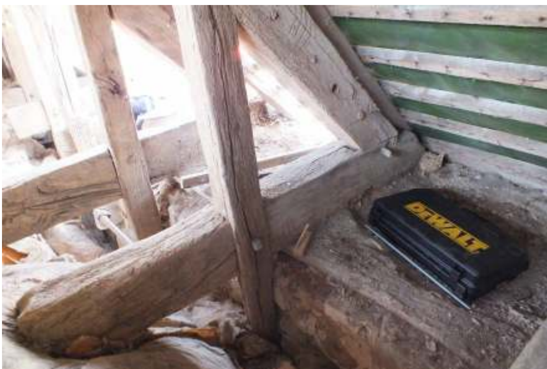
Takstol 4, 5 norra takfallets sticbjälkar och stödben. Närmast på murkrönet syns ett remstycke. På takstolen närmast (takstol 4) syns märkning IIII på både sparre och sticbjälke. Sticbjälken i takstol 5 byttes till nytt ekvirke.
