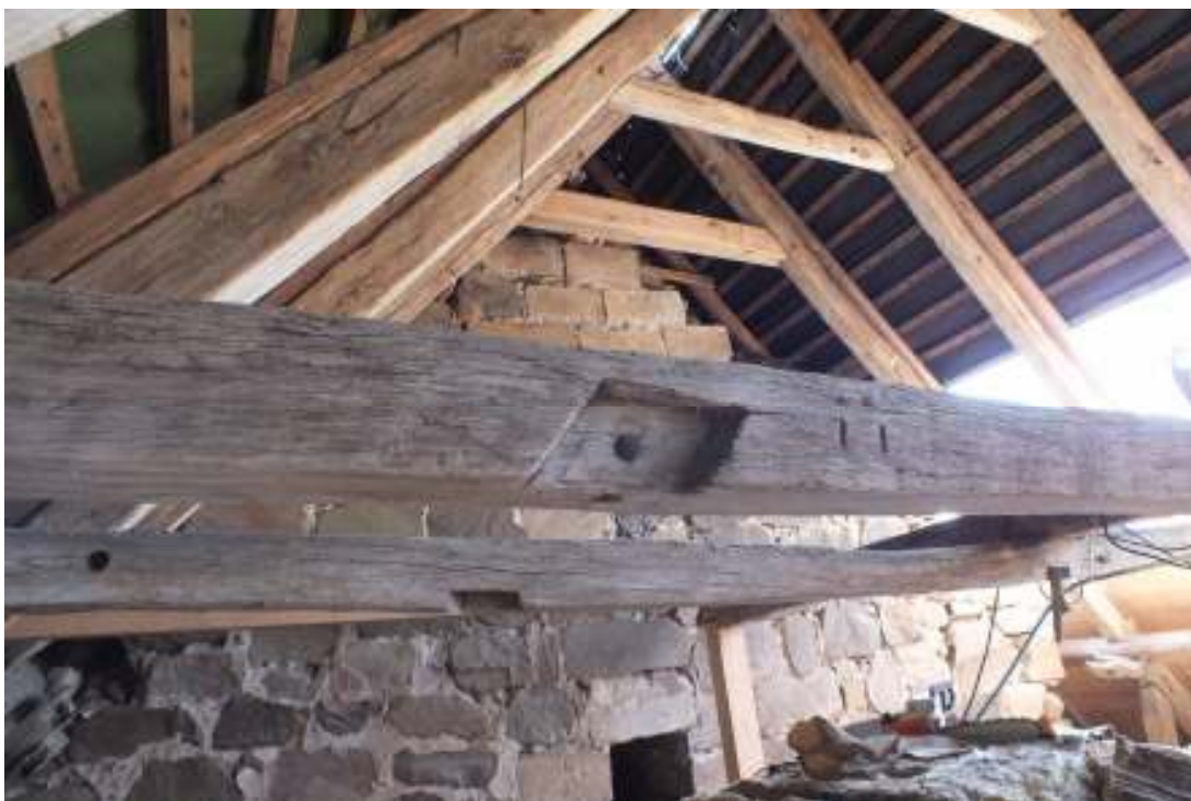
Nedre banbandet (närmast i bild) i takstol 4 med förtagning efter snedsträva. Från nordväst. Förtagning fanns även på södra sidan. Observera att denna takstolsdel är märkt II.
