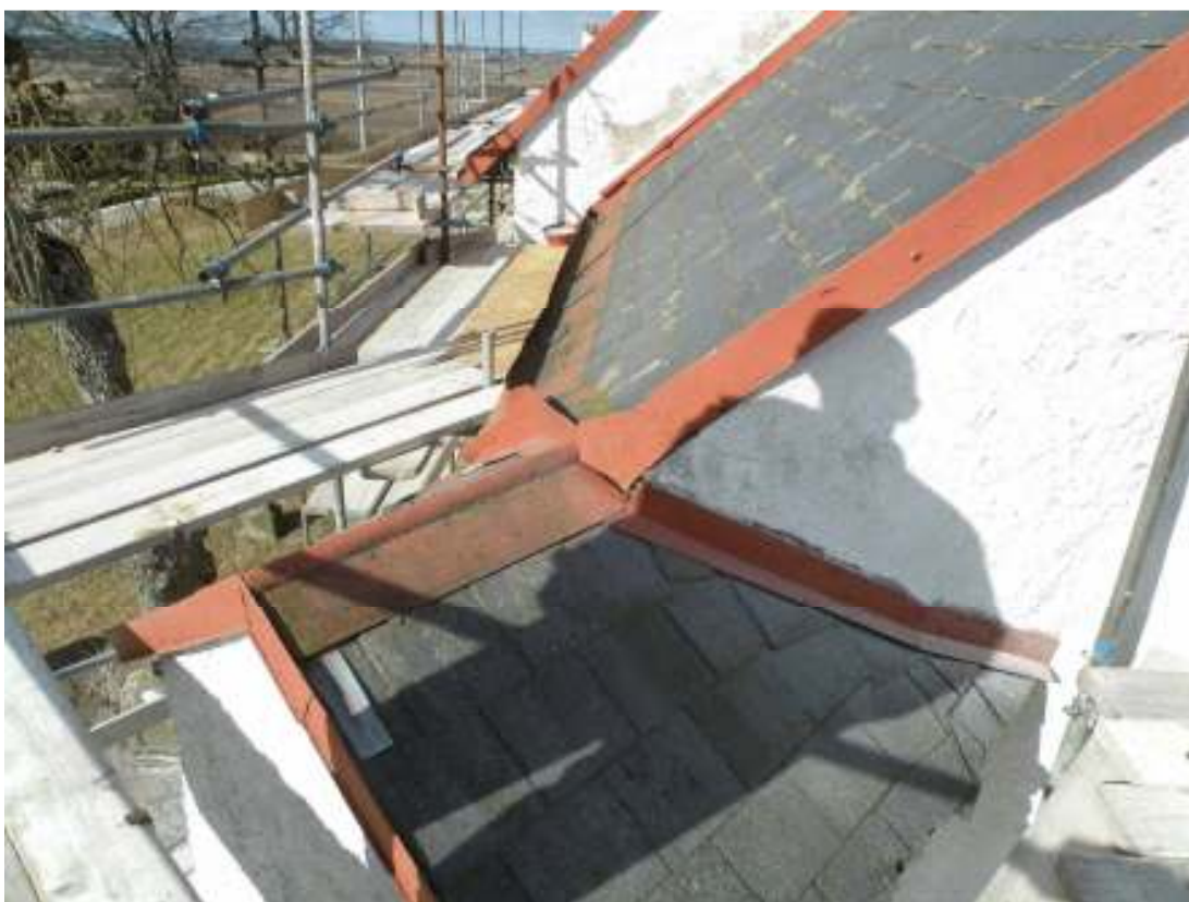
Kyrkans tak före renoveringens början sett från stränpelare vid korets sydöstra sida.
