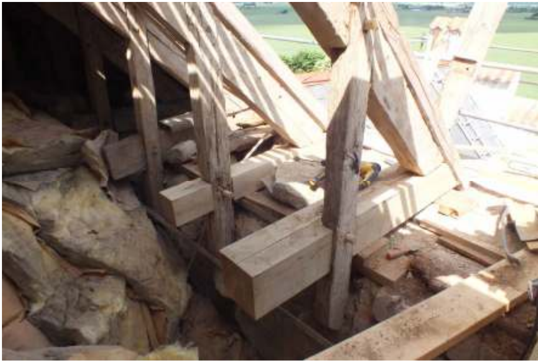
Stickbjälkarna i takstol 5 och 6, norra takfallet, byttes ut mot nytt ekvirke. Fogningen mellan sparre och stickbjälke förstärktes med järnbeslag i båda takstolarna. Kilning under stickbjälkarna utfördes.
