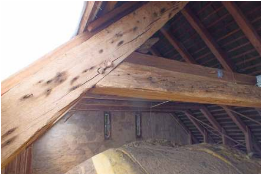
Takstol 10 sett från sydost. Märken efter spikar syntes på sparrens och hanbandets östra sida.
