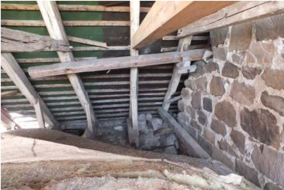
Takstolarna 1-3 norra takfallet. Till höger i bild syns långhusets östra gavelmur. Andra takstolen (från höger räknat) har kompletterats med nytt nedre banband. Till takstolarnas undersida har en bjälke med upplag på gavelmuren fogats.
