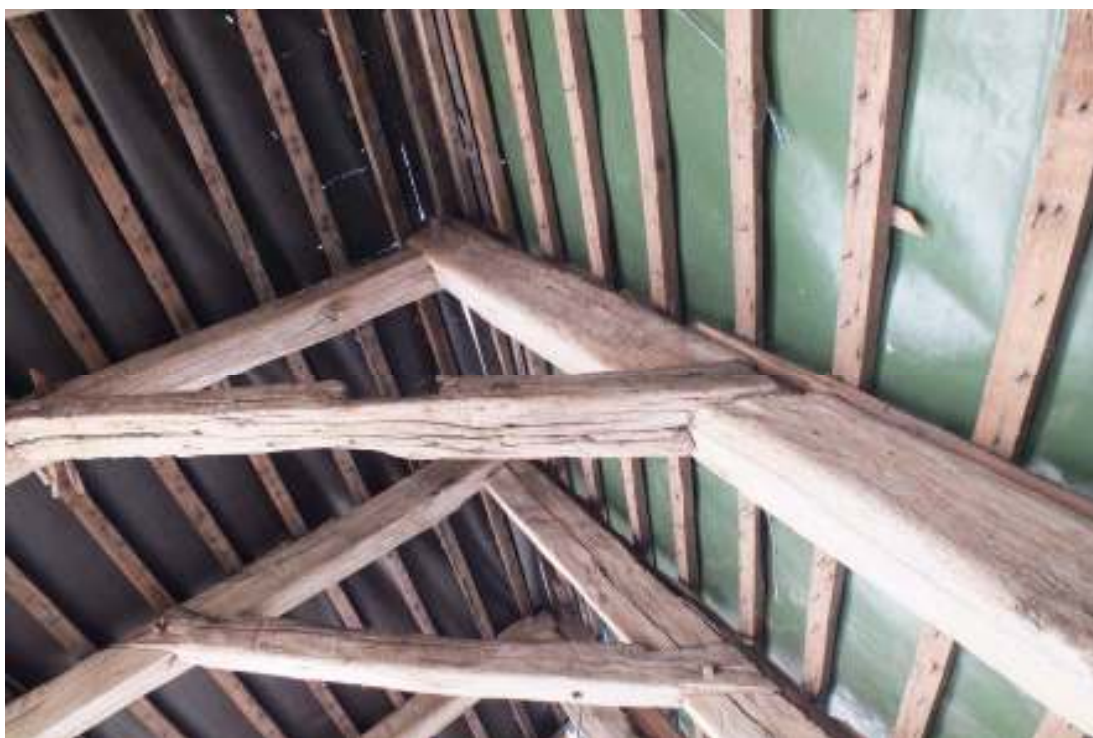
Övre hanband i takstolarna 4 och 5. En förtagning syns på ovasidan av hanbandet i takstol 4, närmast i bild. Märken efter spikar syntes på hanbandets undersida.
