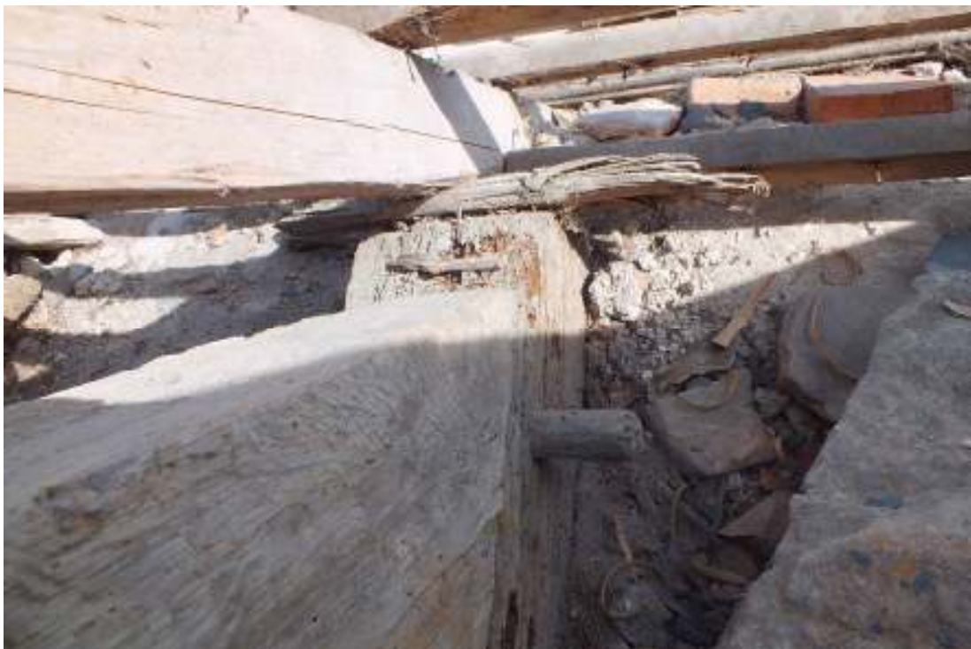
Bilden visar murkrönet uppifrån och stickbjälkens fogning till sparren, norra takfallet takstol 6. Lägg märke till avståndet mellan sparrens nedre ytterkant och stickbjälkens ytterkant.
