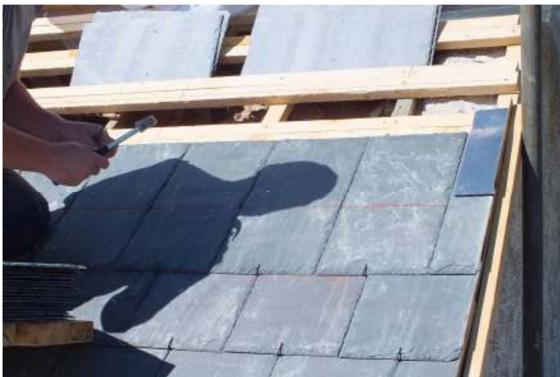
Överst till vänster syns ny läktning på kortaket sett mot söder. Läktningen lades upp över murkrönet. Överst till höger syns undersidan av det färdiga skiffertaket på vapenbuset. Nederst syns läggning av skiffer på kortaket där samtliga plattor lades med stormklammer på södra takfallet.
