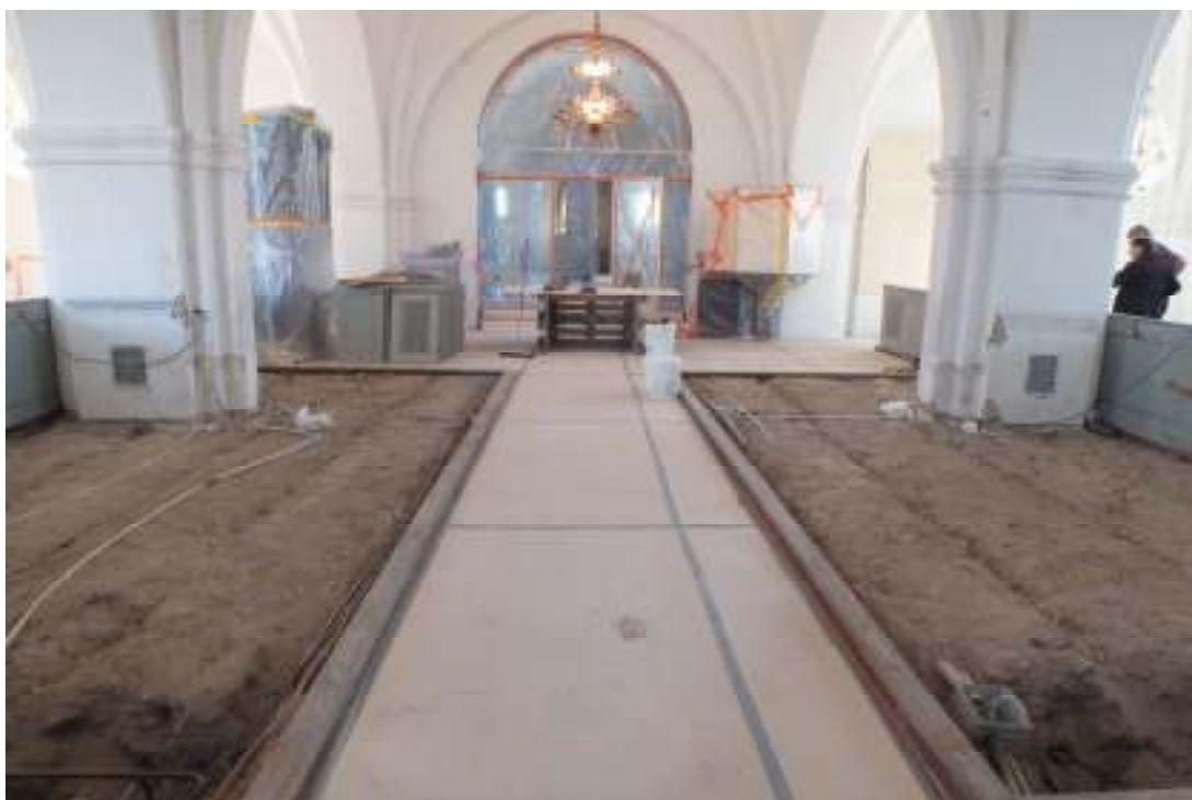
Kyrkan under renovering. Nytt golv på nytt bjälklag lades i södra korsarmen och långhuset utmed mittgången.
