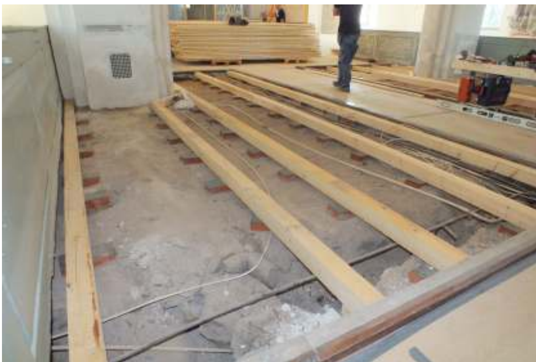
Kyrkans nya golvhjälklag efter att fyllning schaktats bort. Gamla långhusets mursträckning syns svagt mellan de två vänstra bjälkarna. Ventilöppningen i valpelaren i fonden är en rest från kyrkans gamla värmeanläggning då två kaminer var placerade intill valpelarna i mitten.
