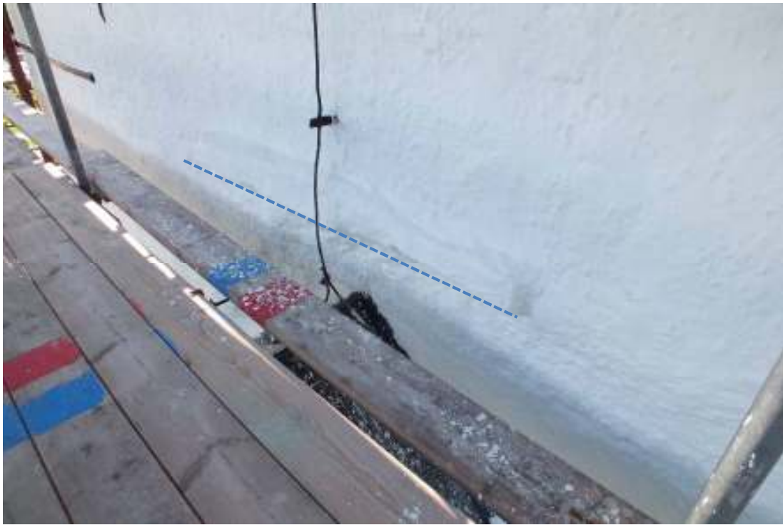
Över långhusetsnock i västra tornmuren finns ett markerat parti möjligen omfattningen till en äldre igensatt öppning. Murpartiet där tornet möter långhusets gavel är påtagligt buligt.
