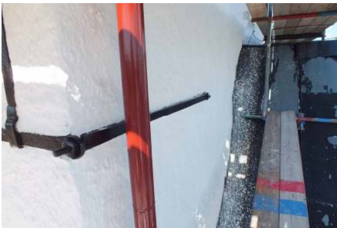
Ett järnband monterat på tornets sydöstra hörn satt inte spänt mot muren. Notera den ojämna murytan utmed långhusets takfall.
