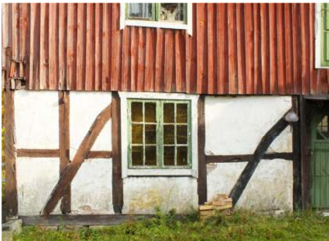
Fig. 3. Kvarnen. Parti av timran som är i behov av mer omfattande reparation.
