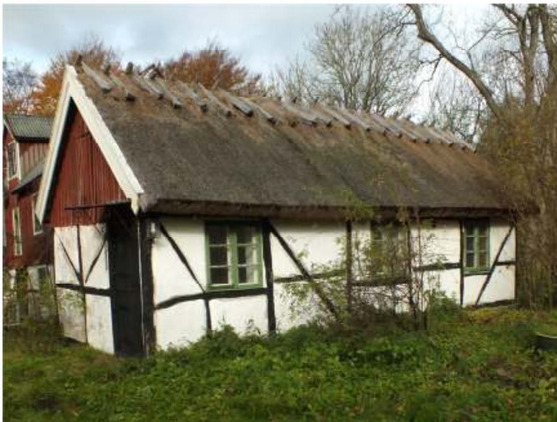
Fig. 5. Svinhuset. Den bitre hörnstolpen inkl. södra fotträet förbrukade.
