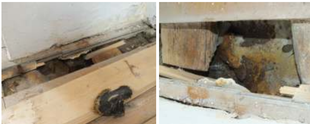
Bilderna visar rötsvampen som hittades i anslutning till murstocken inne i det utrymme där bakugnen tidigare fanns, beläget direkt söder om entrén.
