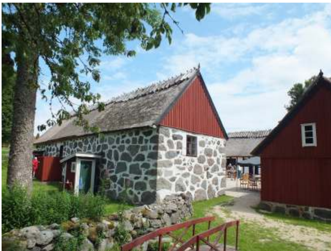
Bilden visar loglängans takfall åt väster. Här syns att taktäckningen har nöts ned så att rafterna ligger i ytan.
