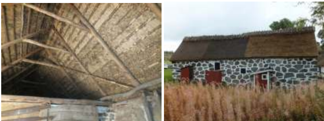
Bilderna visar ny monterad snedstyva följt av bild på takfallet åt väster efter avslutade arbeten.
