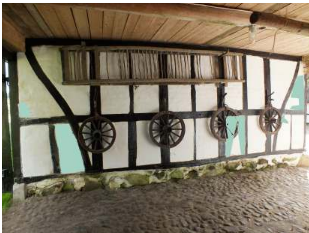
Bilden visar den norra längans västra fasad mot portgenomgången. Färgmarkeringarna visar var mindre omfattande lagningar med ytputs har gjorts.
