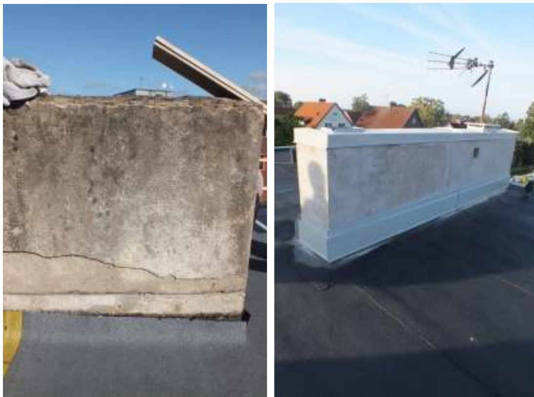
Skorstenen före (t.v.) och efter (t.h.) putslagning och skoning med ny plåt. Skorstenen fick även en ny avtäckning i plåt i syfte att skydda den från väta.
