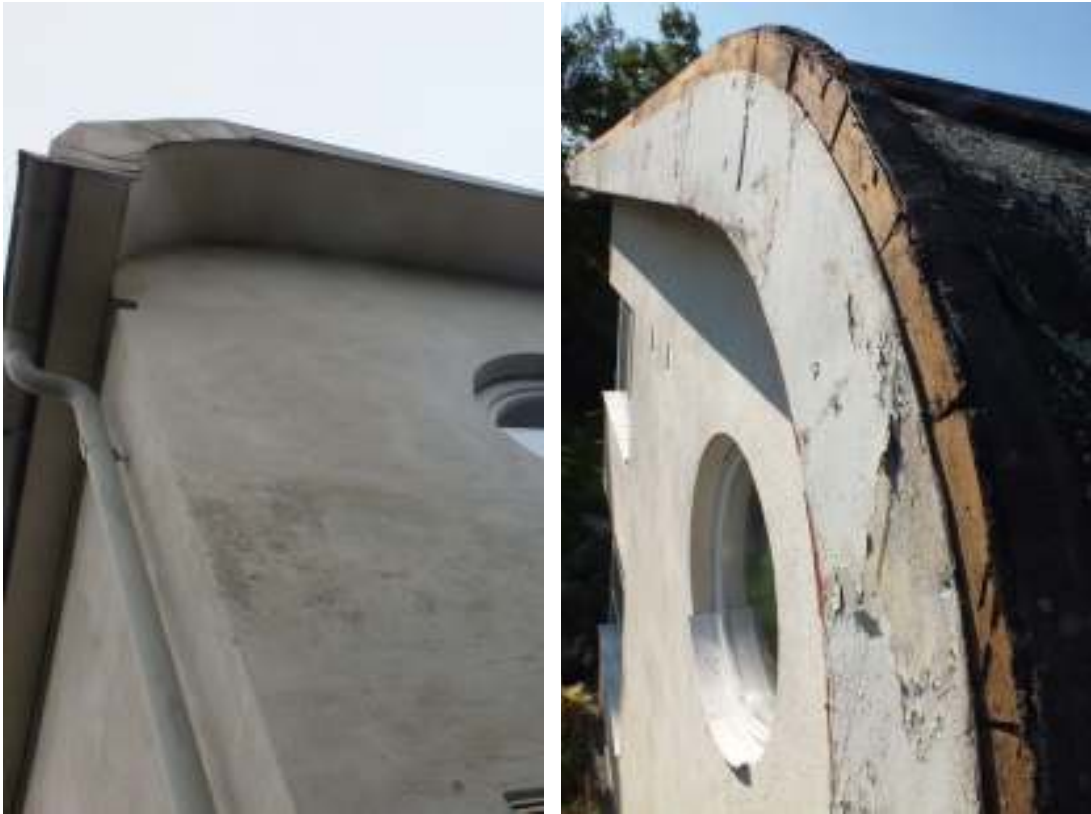
Hängskivorna på västra sidan före renoveringen (t.v.) och på östra sidan efter att den senaste plätens tagits ner (t.h.). Originalplåten hade något nättare proportioner jämfört med idag då en träkil bygger på omkring 5 cm.
