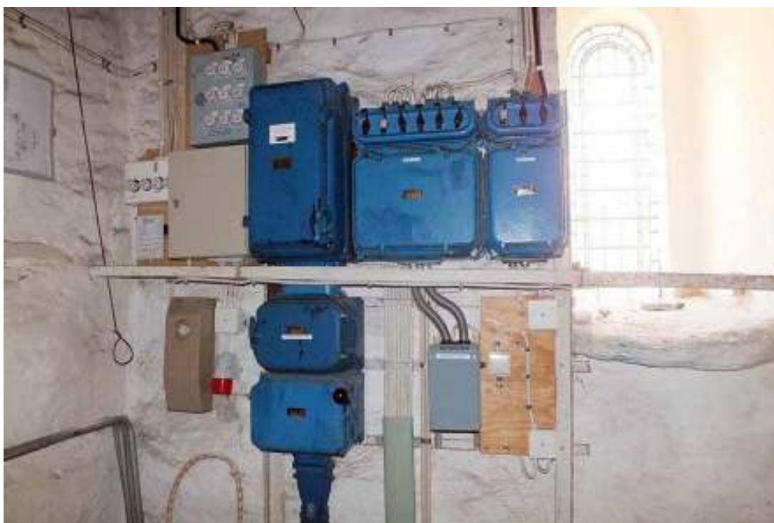
Elcentralen är belägen på tornets andra våning med placering mot västra väggen.
