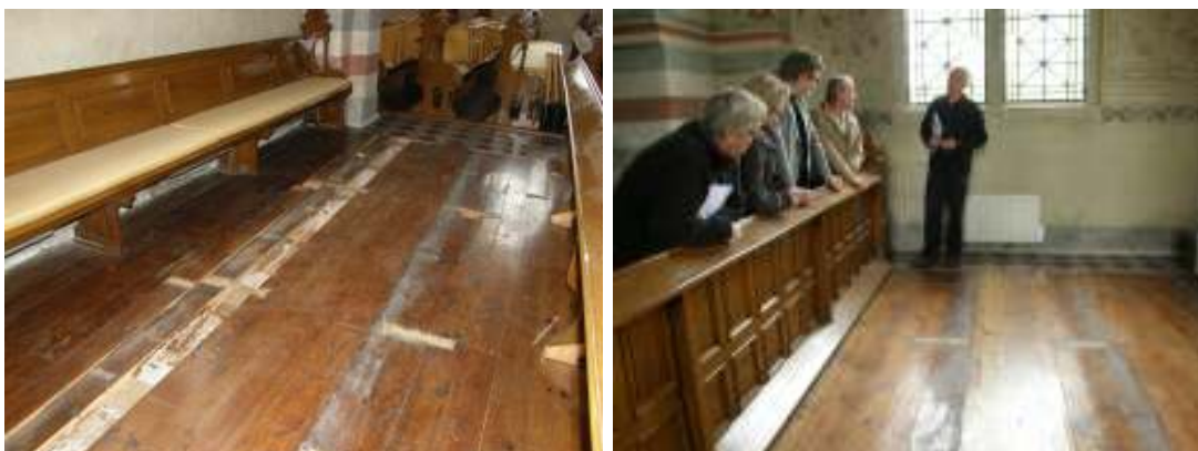
Två av de fasta bänkarna har anlägsnats. Den väggfasta bänken var avsedd att bevaras tills det uppdagades att den var rötskadad. I stället har bänkfronten, på bilden till höger, placerats mot väggen.
