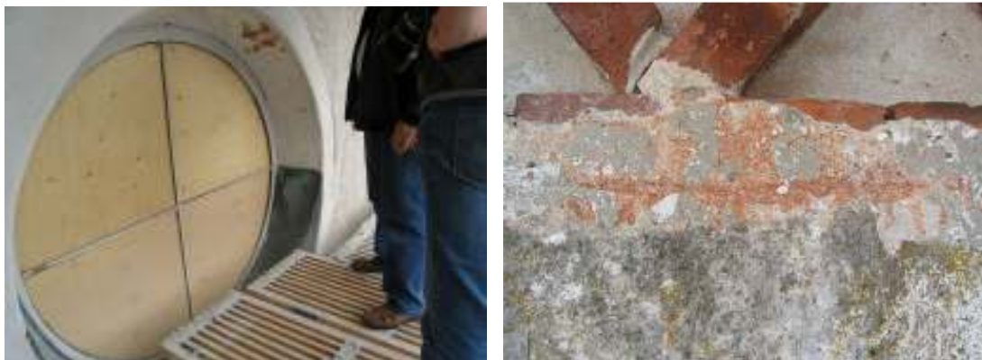
Tegelimiterande bemålning i fönstersmygen ovan västporten. Bilden till höger visar rester av tegelimiterande måleri på ett tunt putslager på tornets östra gavelmur.
