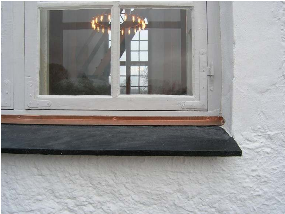
Fönstrens solbänkar har kompletteras med små kopparplåtsbeslag för att minska risken för vatteninträning mellan solbänk av gjutjärn och karmunderstycket.
