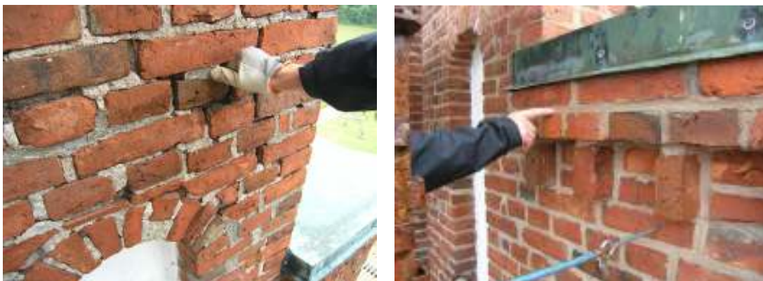
Fogarna på tornets gavelmurar var i mycket dåligt skick. Bruket var ett KC-bruk som flera gånger lagats med ännu hårdare bruk. Bilden till höger visar gavelmuren efter att fogarna frästs ur och fogats om.
