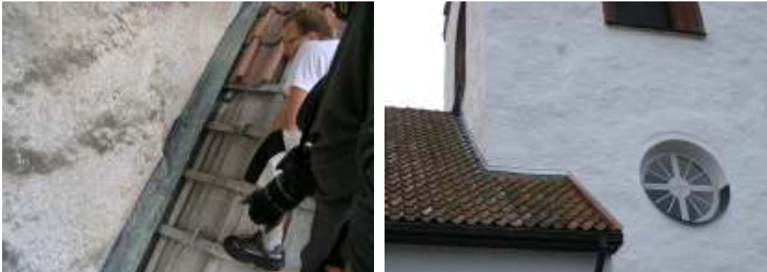
Långhusets anslutning mot tornfasaden där läckage uppstått. Bilden till höger visar slutlig lösning med blyplåt samt rostfri plåt, på plåtslagarens eget initiativ.
