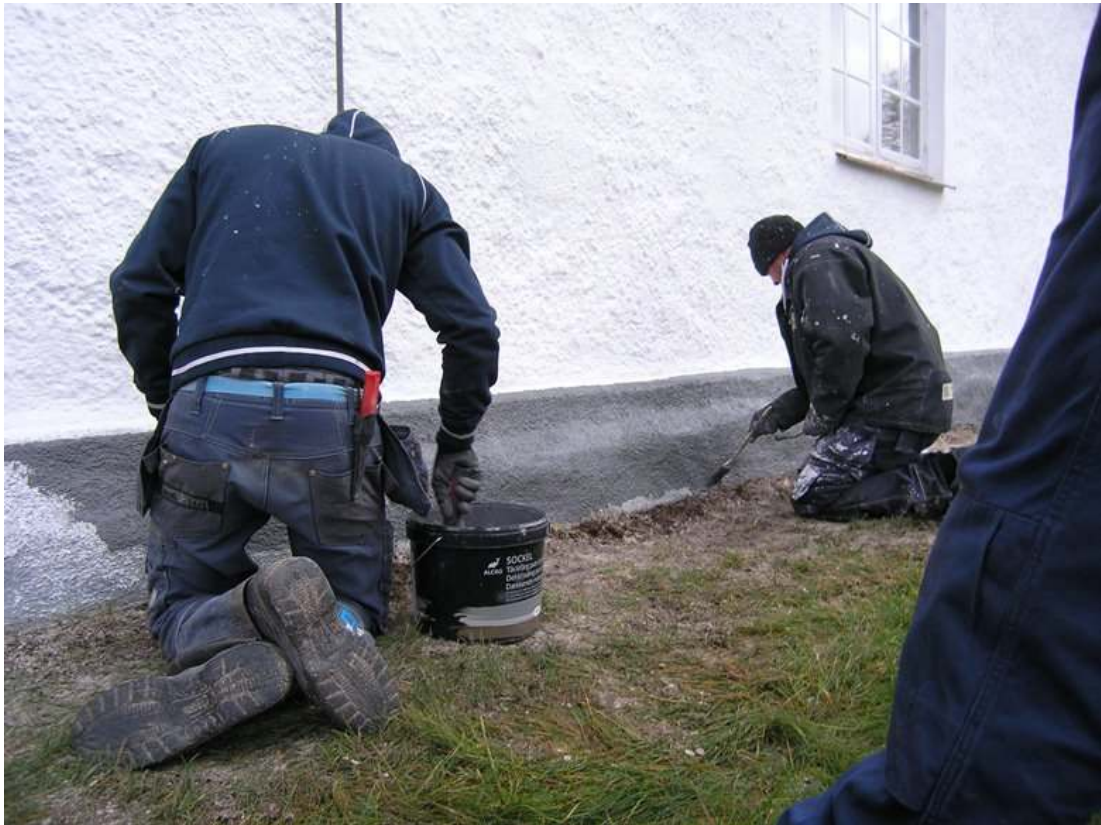
Kyrkans sockel har målats med akrylatfärg från Beckers. Detta har skett utan samråd med vare sig byggherre eller medverkande antikevarie.
