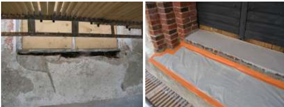
Till vänster rötskadat karmunderstycke i tornets bottenvåning, södra fasaden. Till höger gjutning för bättre avrinning har gjorts på samtliga ljudluckors tröskelpartier. Trösklarna har sedan försetts med plåtintäckning av koppar.
