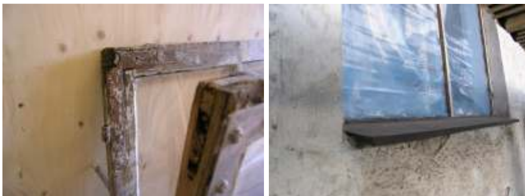
Till vänster en typisk fönsterskada. Bilden till höger visar en av solbänkarna av gjutjärn före demontering.
