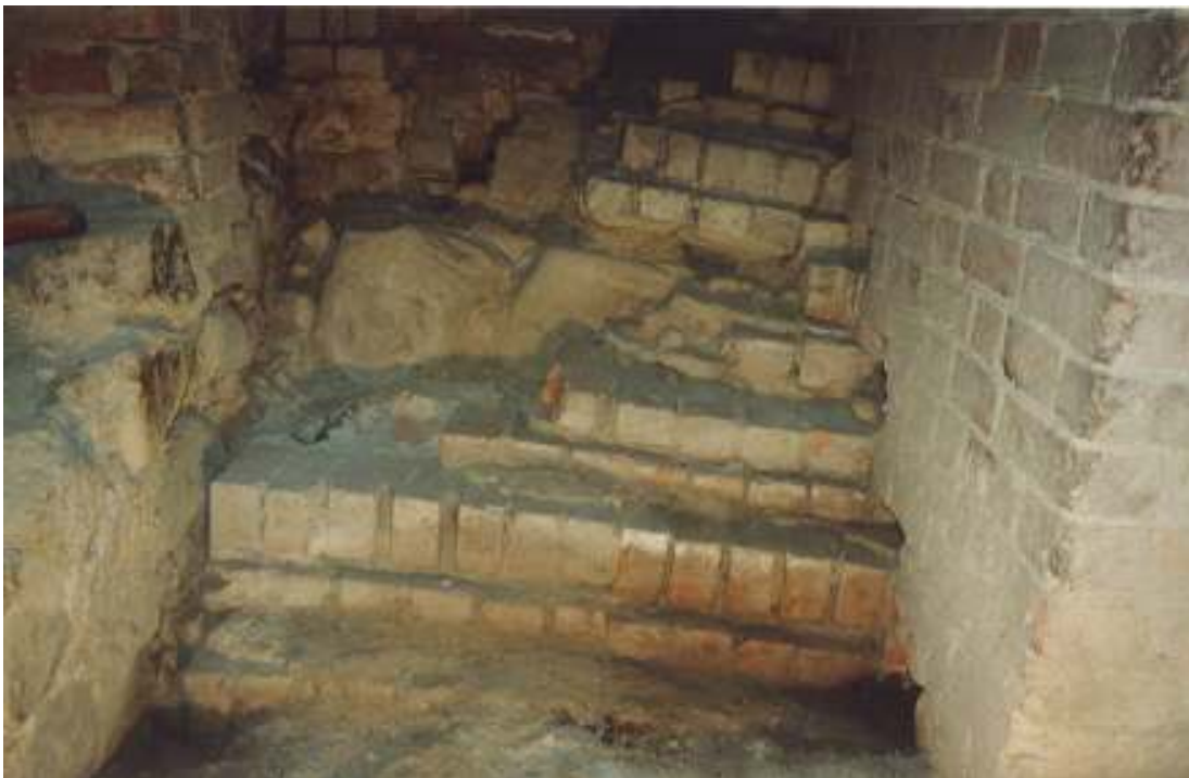
Fig. 9. Vy mot norra trappan. Notera sprickan! Kristina Nilén 2001.
