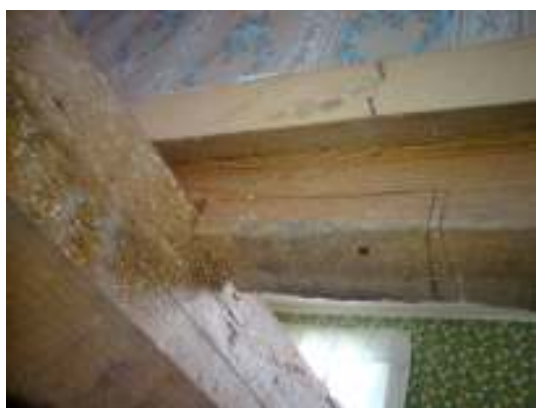
Fig. 5. Urtaget i mellanväggens fotträ.
