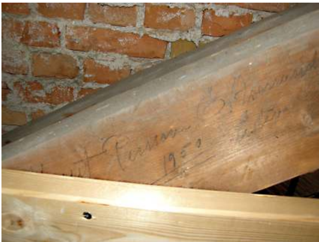
Handskriven anteckning på takstolsbjälke mot öster, långhusets vind. Namnet "Persson", ortsnamnet "Eslöv" och året "1950" kan med bestämdhet urskiljas.
