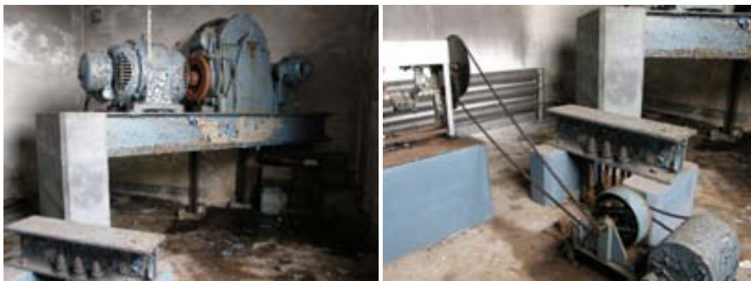
Övanpå den lokal där tarmrenseriet tidigare låg finns ett litet utrymme som fortfarande har kvar sin processutrustning, hissmaskineriet. Här syns bland annat den kraftigt anfrätta hissmotorn.
