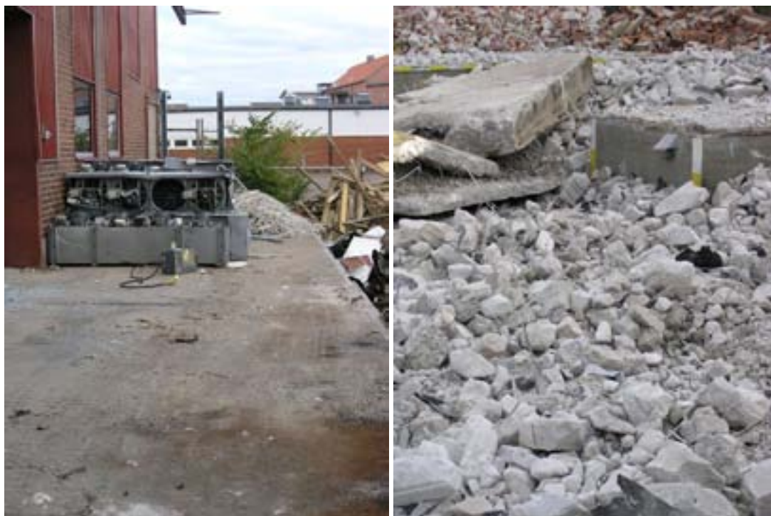
Materialåtervinningen i samband med rivningen är omfattande. Idag sorteras i stort sett allt material för sig, såsom trä, metall och plast. Därför fungerar del av fastigheten Sockerbruket 11 också som sortergård under pågående rivning.
