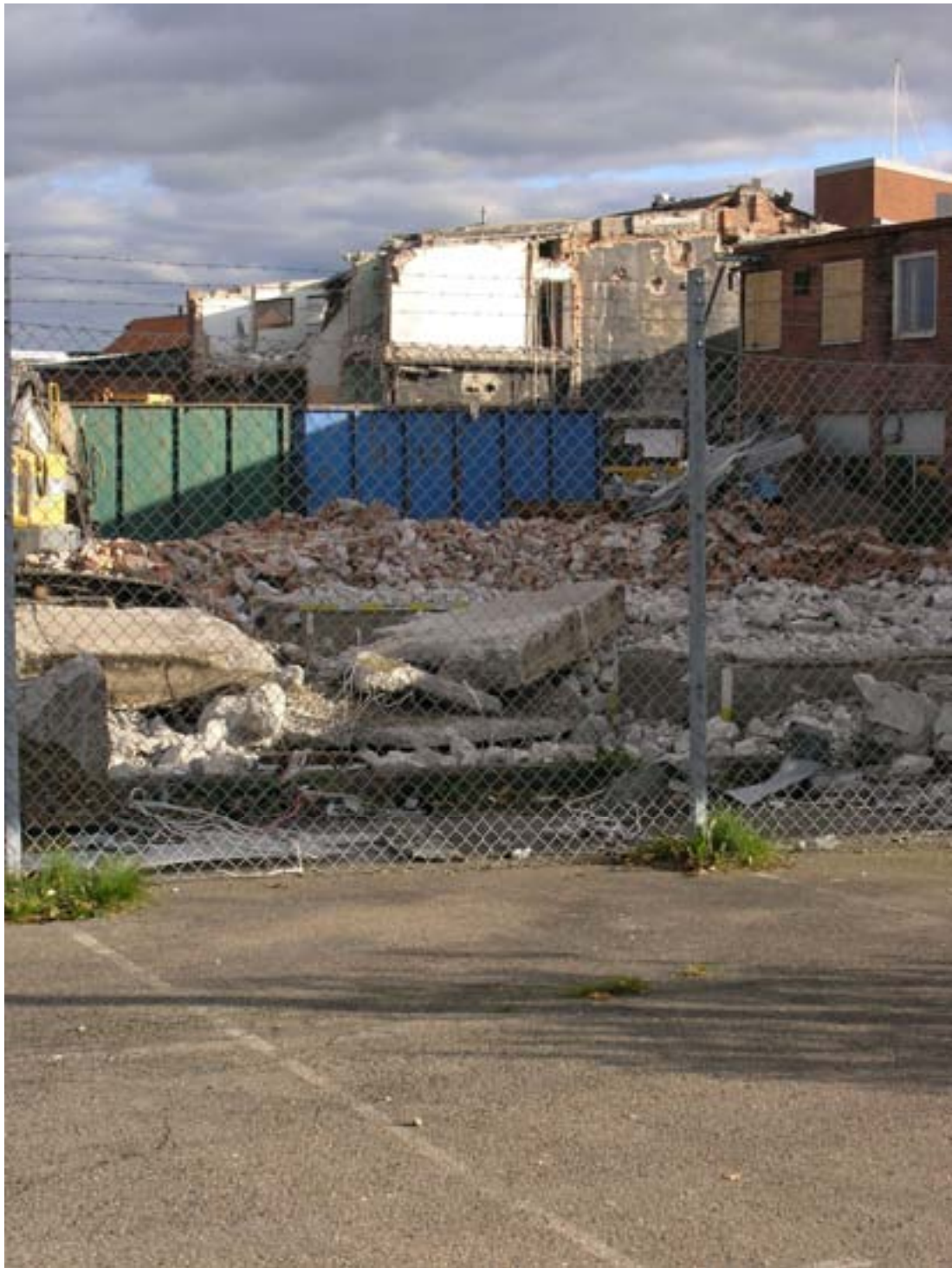
Solen bröt igenom under en kort paus i rivningen. Kaos och vemod fick samsas med en modern ruinromantik. Kanske är det förgängligheten, det faktum att sceneriet snart lämnar plats för något helt nytt, som är tilltalande.
