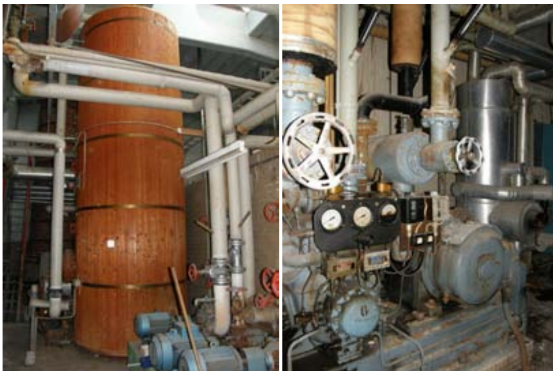
Till vänster tronar det väldiga och träinklädda varmvattenberedaren. Till höger syns del av den gigantiska kylanläggningen med sina många kompressorer. Som köldmedium användes ammoniak och tidigare anställda berättar att det hände att de snabbt fick utrymma sina arbetslokaler i samband med läckage från anläggningen.
