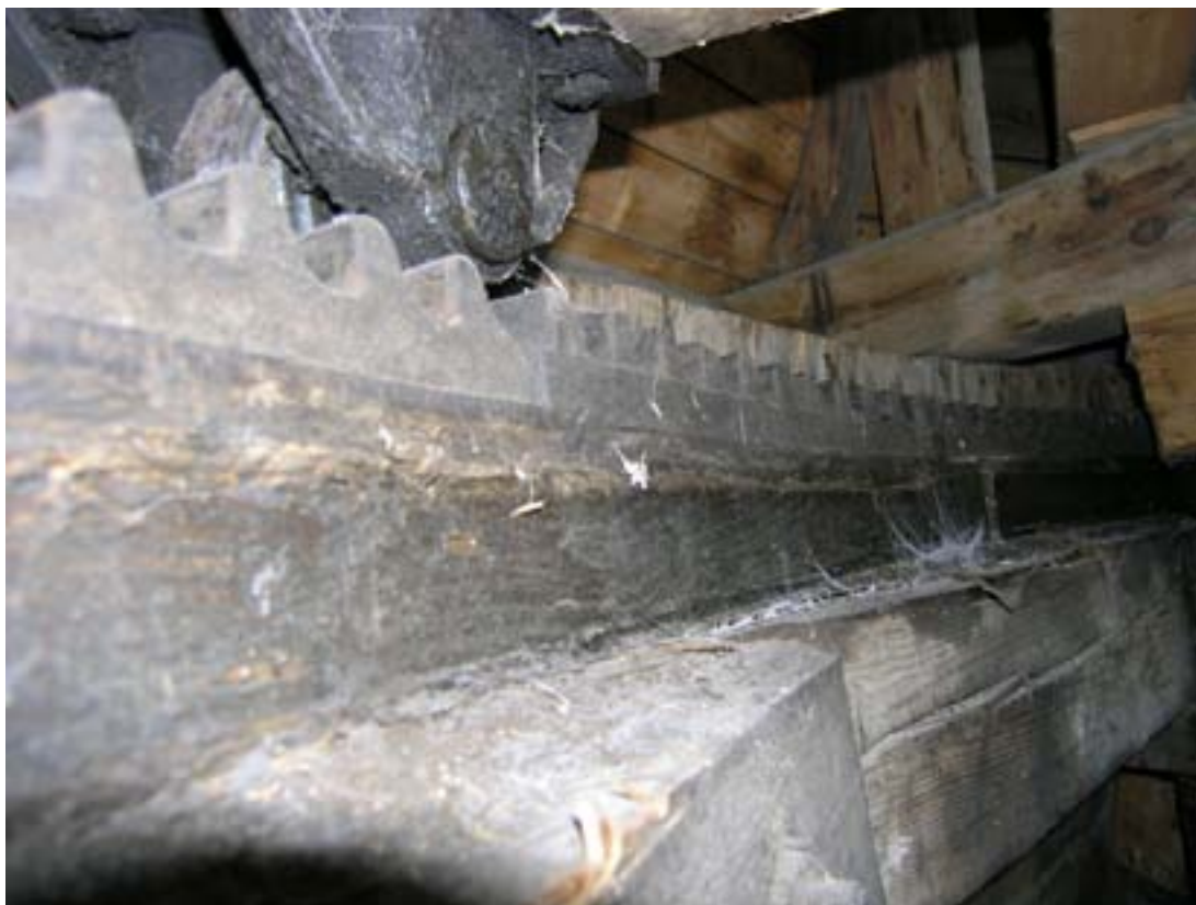
Detalj som visar slitage på kuggkransen innan lagningen
