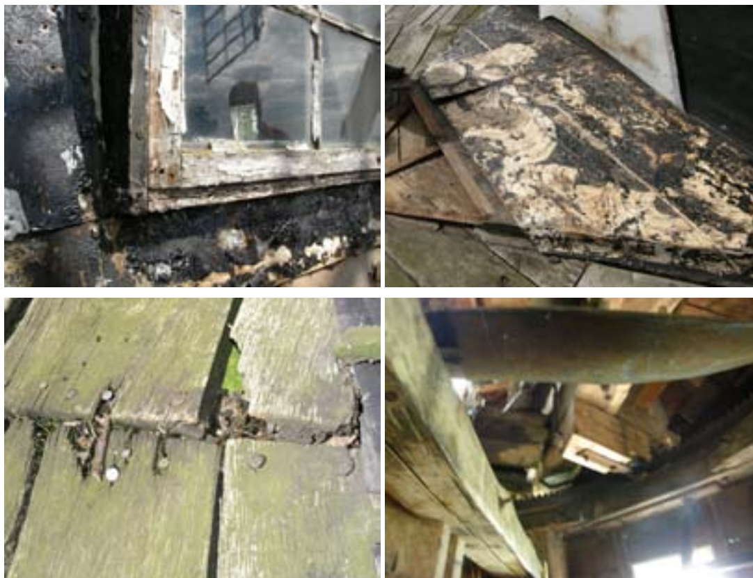
Innan renoveringen; över, papptäckning och fönster under, murkna brädor på omgången
