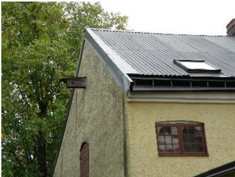
Att den nordöstra gaveln buktar inåt kan ans på bilden. Här ses även de specialanpassade vind- och vattenplåtarna
