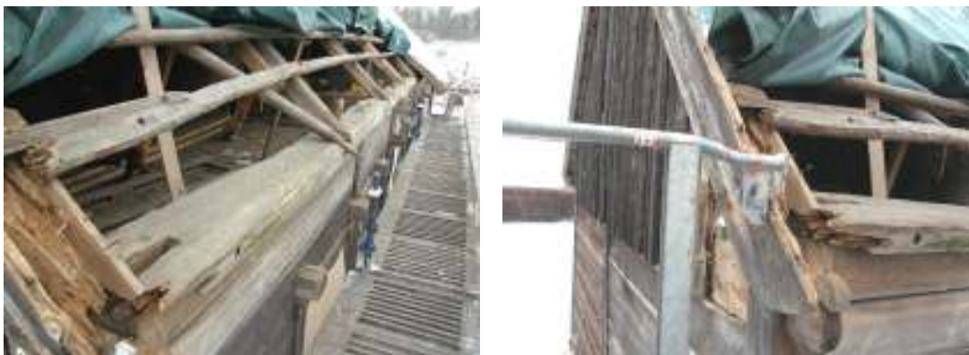
På den vänstra bilden syns lejden som har ersatts vid årets arbeten. Till höger finns en närbild av rötskadan i det sydöstra hörnet av byggnaden. Förutom lejden var även sparren, vindskeivan och solbrädan rötskadade.
