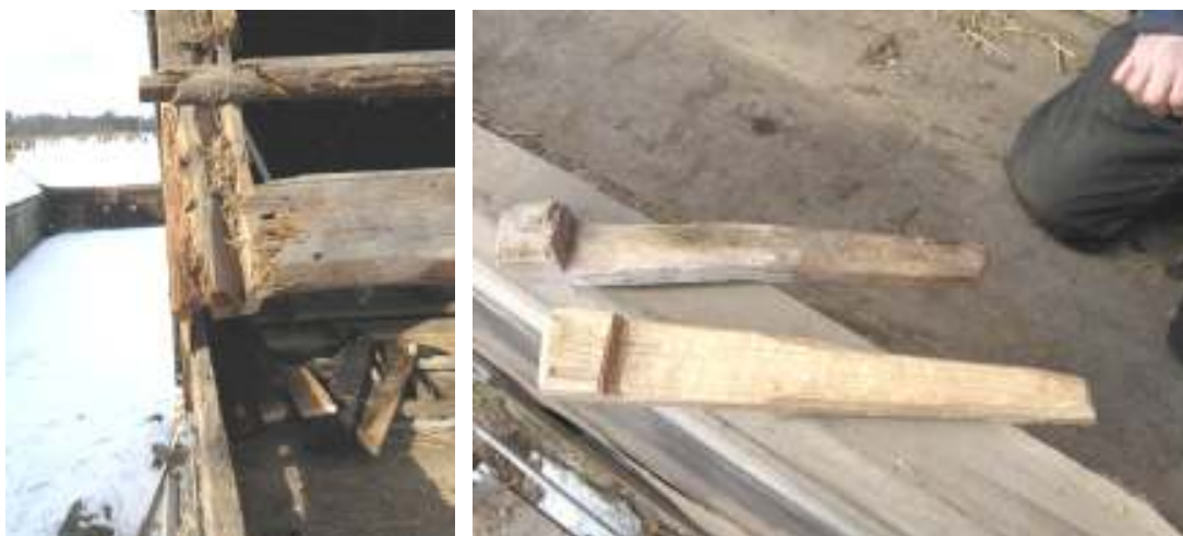
På den vänstra bilden syns den rötskadade sparren och på den högra bilden befintlig dubb överst och nyttillverkad under den.
