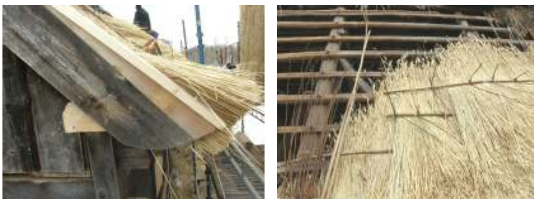
Bilderna visar vindskiva och solbräda efter lagning/byte samt det pågående arbetet med halmtäckningen.
