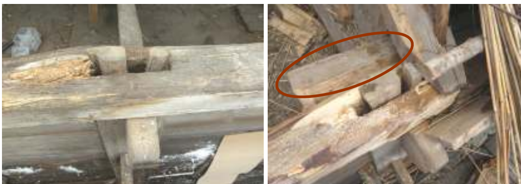
Rötskada i anslutning till stolpe samt ny lejd på plats invid förstärkningsbjälke, inringad, till mötande lejd.
