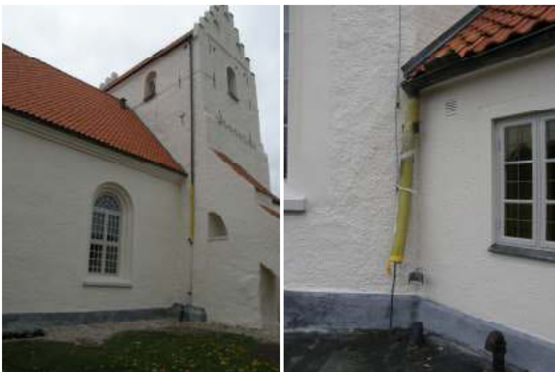
Stulna stuprör på kyrkans norra och östra fasader.
