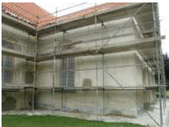
Exempel på putslagningar på södra korsarmen.
