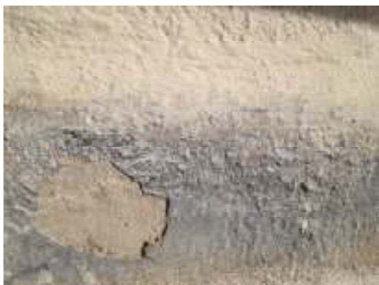
Puttskador på sockeln.
