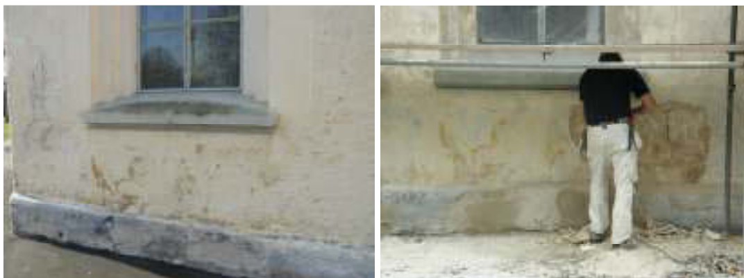
Missfärgningar i putsen på koravslutningen(t.v.), samt arbetet med borttagning av putsen (t.h.).
