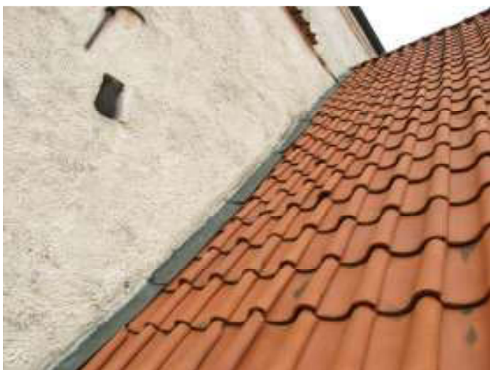
Den dåligt förankrade ståndskeivan mot tornet på södra takfallet.
