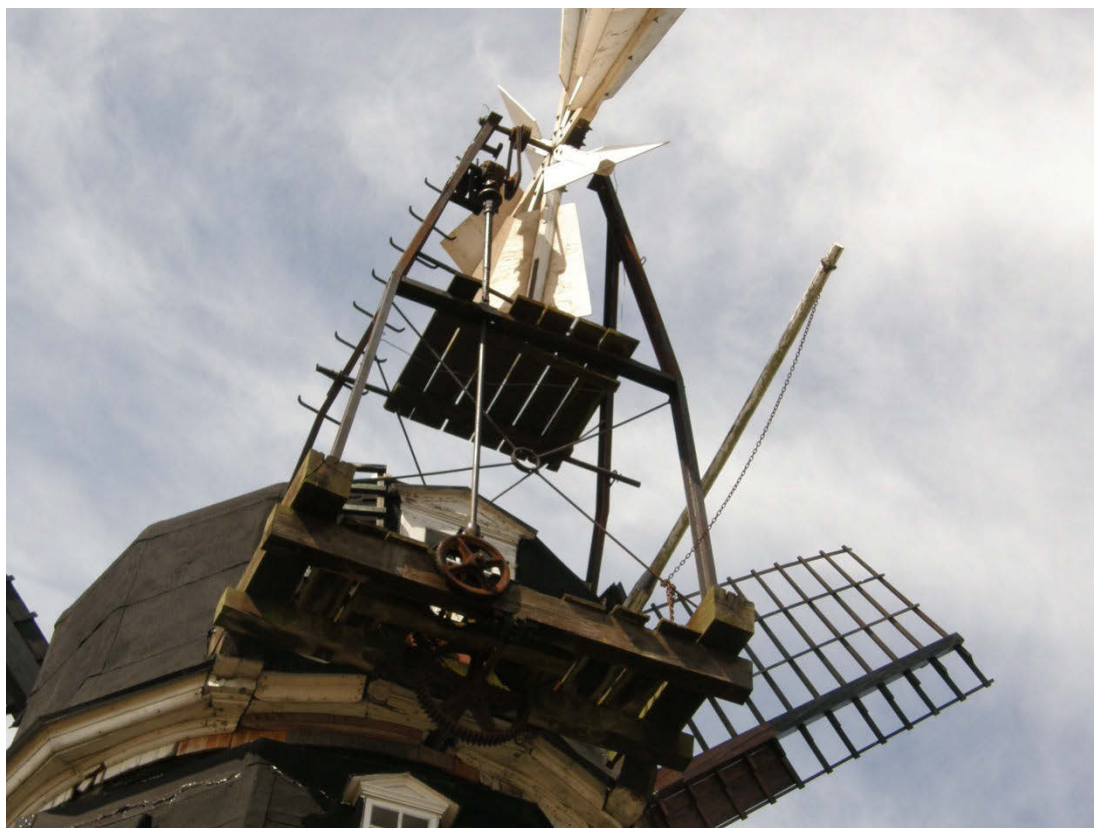
Balkongen med självdrejningsmekanismen före renoveringen. Även skadorna på pappen och sargens slitna målning syns.
