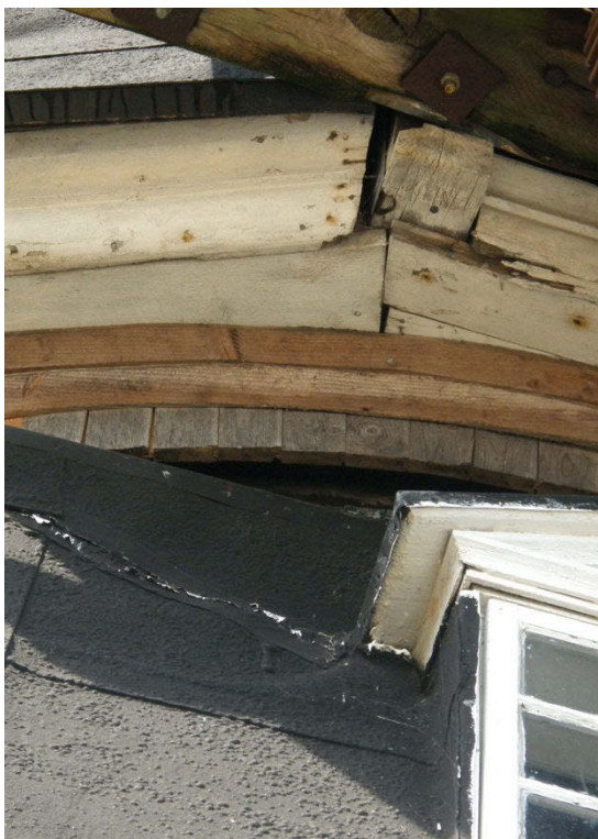
Sargen och den skadade pappen före åtgärderna
