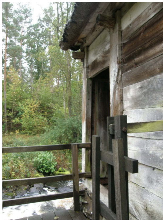
Byggnadens lutning är synlig för blotta ögat.
