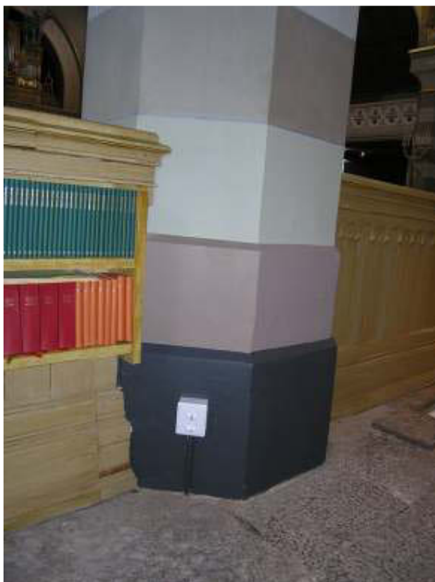
Flera av de pelare som bär upp läktarna var skadade i basen. Dessa har reparerats och målats med emulsionsfärg.
