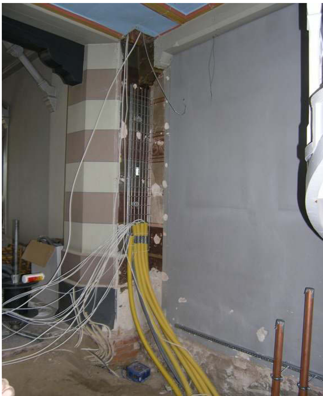
Ursprungligt måleri som dolts av installationer. Målningen har lämnats orörd men är även fortsättningsvis inbyggd bakom installationer. Denna är belägen i förberedelserummets sydvästra del.
