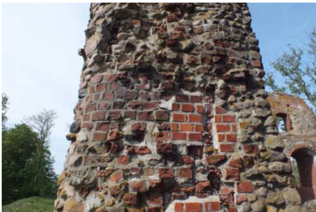
Fotografi taget mot väster i den östra muröppningen, södra fasaden. Sprickor och håligheter i murverket kan leda till att sten bryts loss av vatten och frost.
