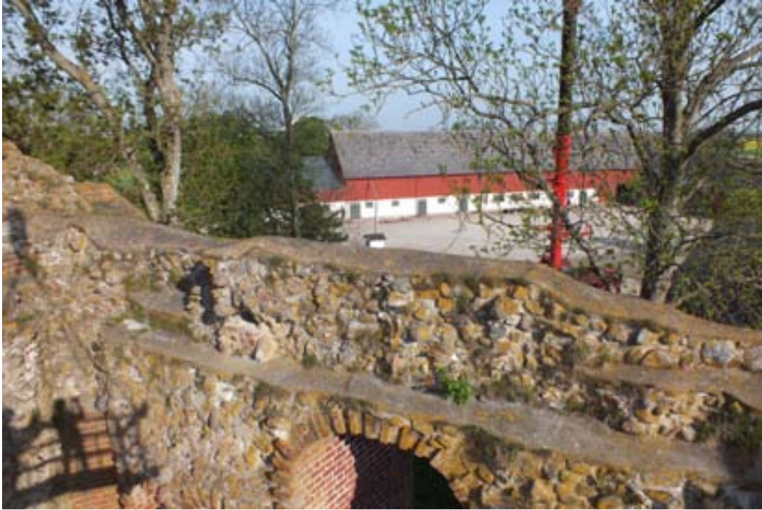
Norra murkrönet. Murkrönets avtäckning är i gott skick. Vid de lägre avsatserna och böga mursidorna finns omfattande växtlighet.
