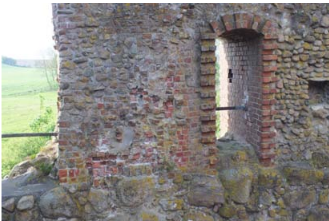
Södra murens insida intill östra öppningen. Här finns en del ytliga skador i muren.
