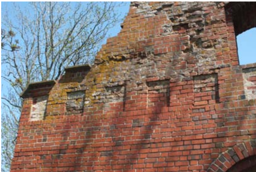
Västra gavelns övre norra parti. Murverket består delvis av tegel med gamla skador. Fogarna behöver kompletteras.
