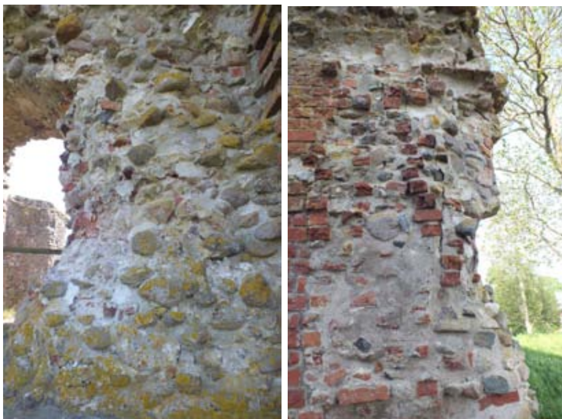
Intill östra öppningen, norra fasaden, finns omfattande vittring i fogbruk och tegelsten längs västra kanten. Sten lossnar och faller ned. Den högra bilden visar öppningens västra mursida. En spricka löper längs norra kanten.
