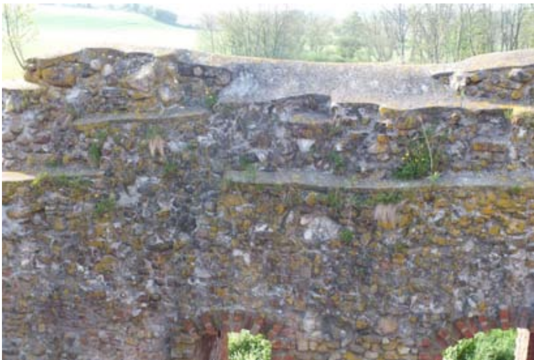
Södra murkrönet mot sett från insidan av borgen. Avtäckningarna är i gott skick med enstaka mindre sprickor. I murverket nedanför avtäckningen finns omfattande biologisk påväxt liksom på mursidorna intill.
