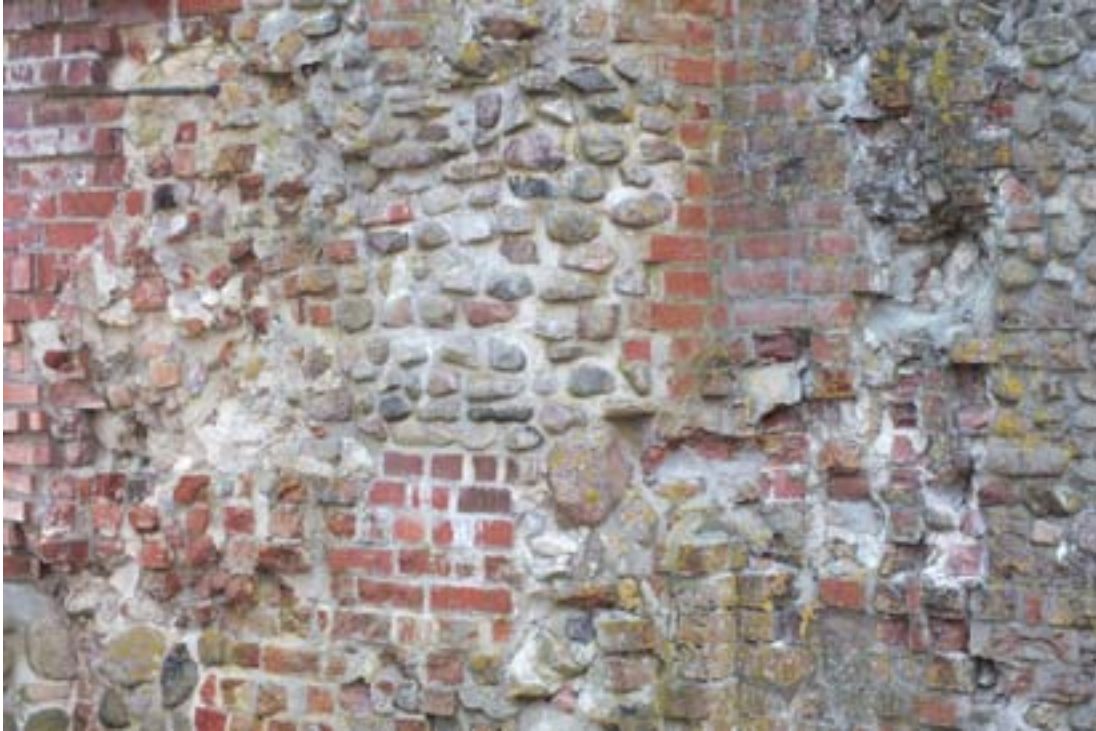
Sydöstra hörnet kring och över fönsteröppningen på södra muren har skador i form av frostsprängt tegel och bortfallen sten och bruk.
