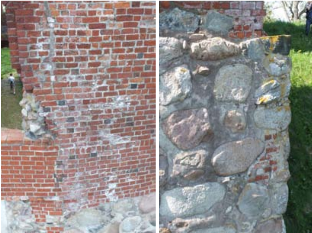
Bilden till vänster visar ett parti i andra våningsplan något norr om portöppningen. En lodrät spricka går rakt genom fasaden vilket kan ha att göra med en äldre lagning/ ommurning. I grästensmurverket vid norra sidan syns en svag spricka. Över denna finns ett parti med skadat tegelmurverk som fortsätter in på norra fasaden.
