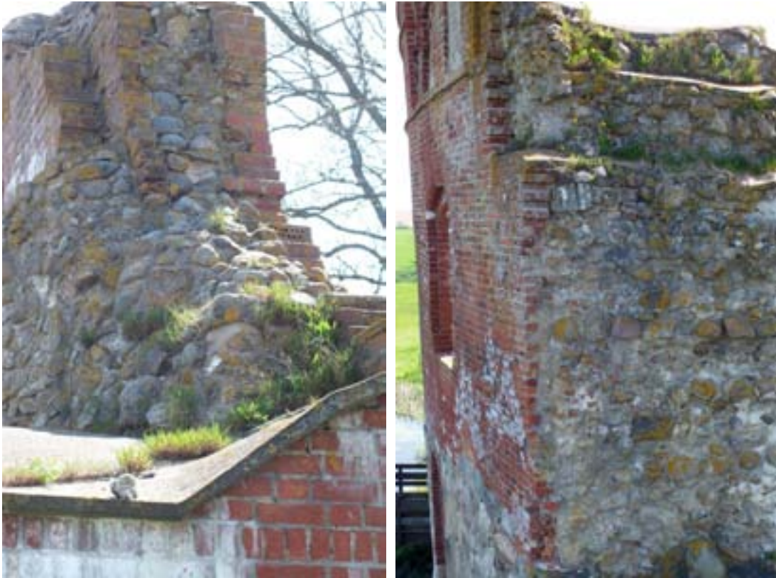
T.v: Intill västra gaveln på norra mursidan finns mycket växtlighet på murkrönet som saknar avtäckning här och en del sten har lossnat.
