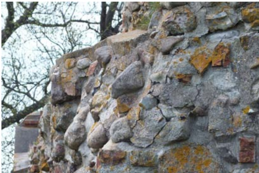
Detalj av murverket i södra fasaden intill östra gaveln. Fogbruket har börjat spricka upp och stor risk för nedfallande sten finns.
