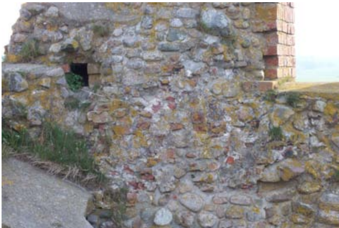
Skadat murverk vid östra gavelns norra del i böjd med tredje våningen.
