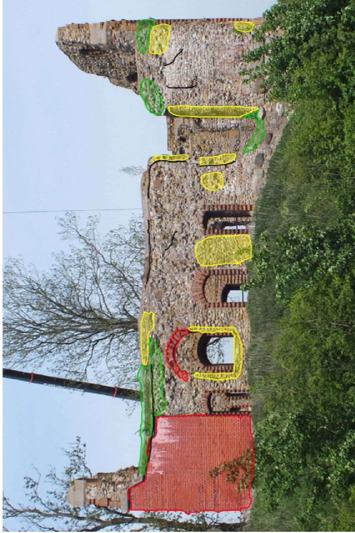
3. Södra fasaden uppvisar fogskeador i tegelmurverket i väster samt i grästensmurverket. Risk för nedfallande stenar finns. En del biologisk påväxt finns framför allt i de övre partierna och i nederkanterna samt under muravsatsen till den östra öppningen.
