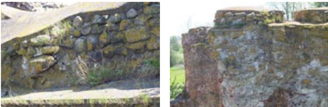
Stenar intill norra murkrönet har börjat lossna där fogbruket har vittrat bort och växtligheten fått fäste.
