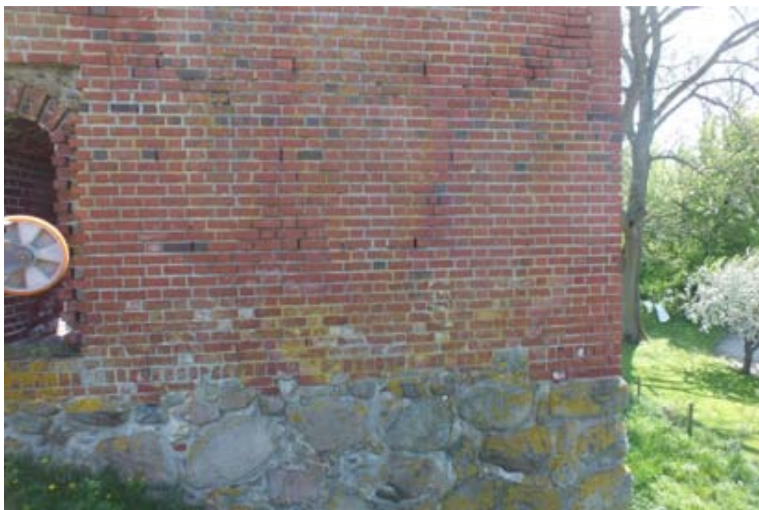
Norra fasadens västra del består av ett skalmurverk med en äldre gråstensmur underst och över detta syns ett modernt tegelskal. En del fogbruk saknas i murverket.
