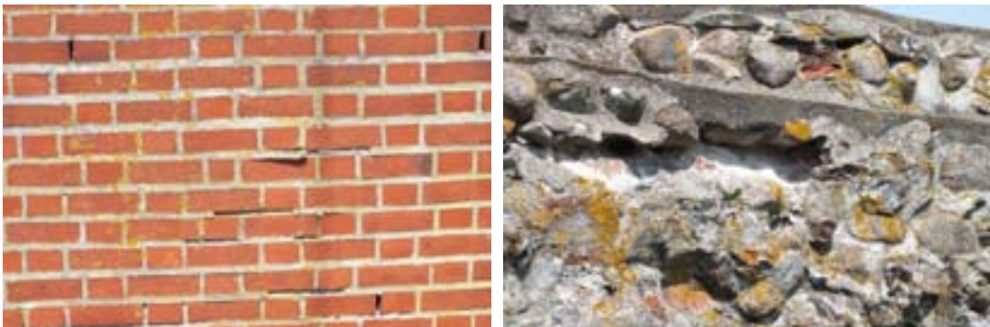
Exempel på skador med bortfallet eller löst fogbruk i södra fasaden. I bilden till höger har stenarna lossnat och fallit ned.
