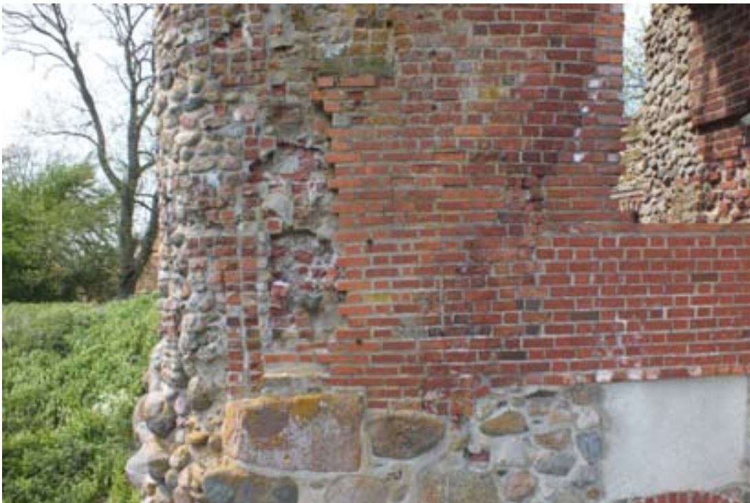
I södra delen av östra gavelns tegelfasad finns en del skador med frostsprängt tegel, lös sten och löst fogbruk.
