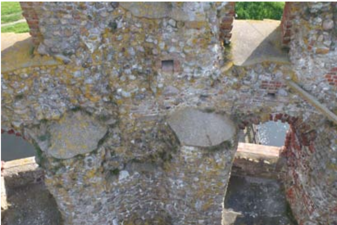
På östra gavelns insida har växtlighet fått fäste på avsatserna och i håligheter vid andra våningen. En spricka finns i avsatsen till fönsteröppningen uppe till höger i bild.
