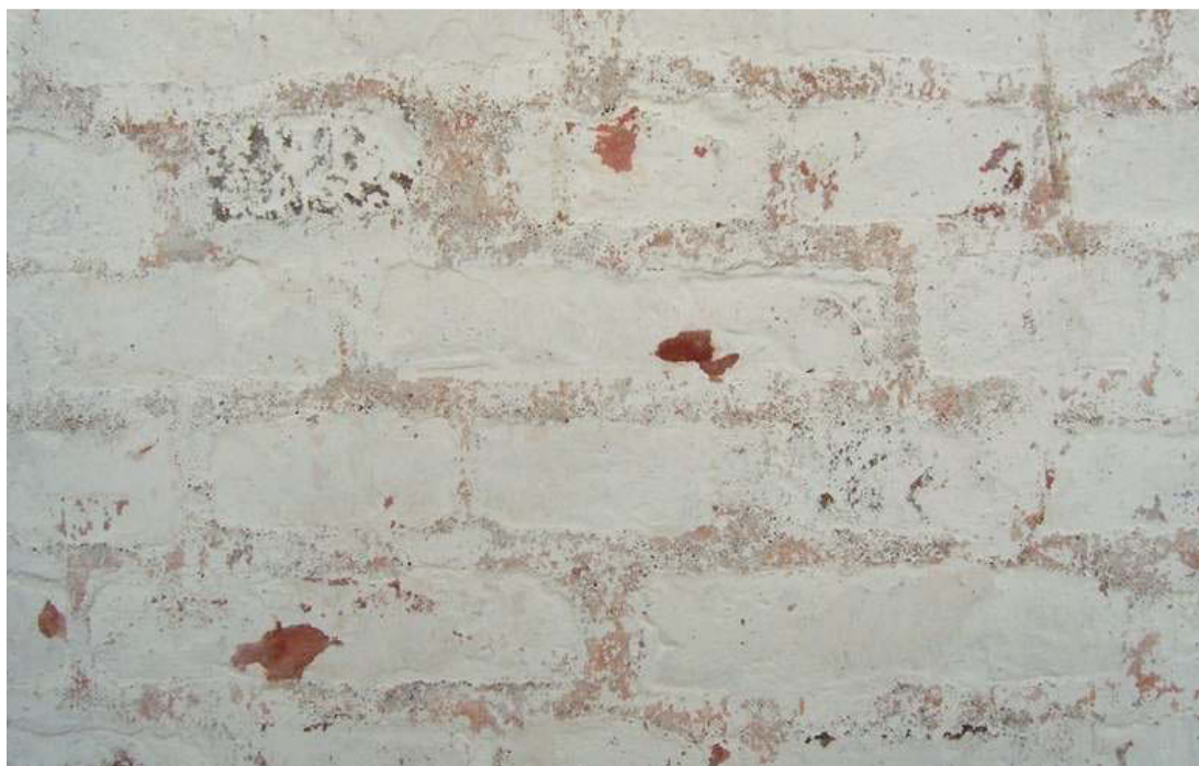
På sakristian bryter den sannolikt ursprungliga färgsättningen igenom kalkavfärgningen. Sakristians fasad har rengjorts varsamt, färglagren stabiliserats genom kalkvattnig och sedan har samma avfärgning gjorts som på övriga kyrkan.
