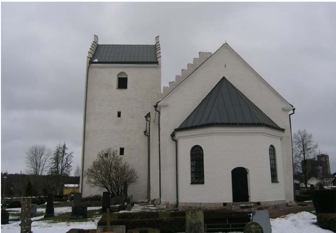
Övre bilden visar det färdiglagda plåttaket samt plåttäckningar på tornets trappstegsgavel. Den nedre bilden visar kyrkans östra fasad efter färdigställd renovering.
