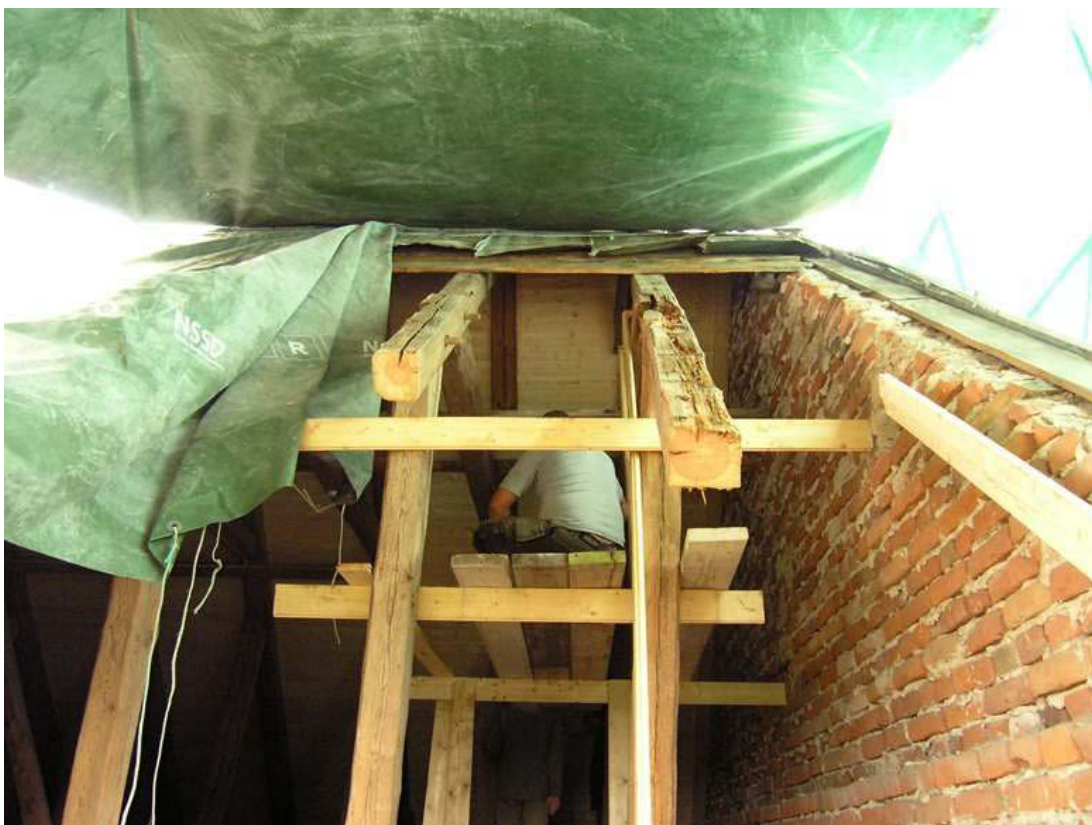
Den övre bilden visar lagningar av takstolsfötter på korets norra mur. Den nedre bilden visar skadade takstolar som kapats för att skarvas med friskt virke, även denna bild tagen över koret.
