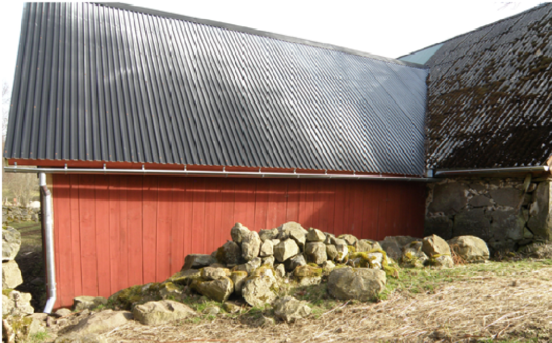
Fig. 17. Östra längans västra fasad. Hängrännan på garagets norra sida.
