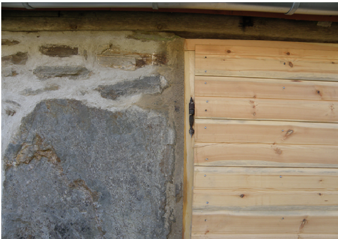
Fig. 10. Nytt gångjärn. Notera kalkbruksfogen.
