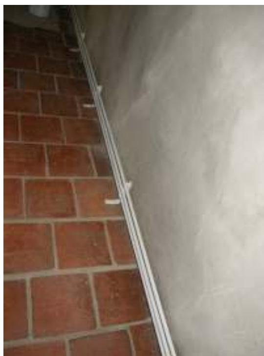
Exempel på de tre rör som går längs väggarna, de två översta för värmen, det understa är hörslingan.
