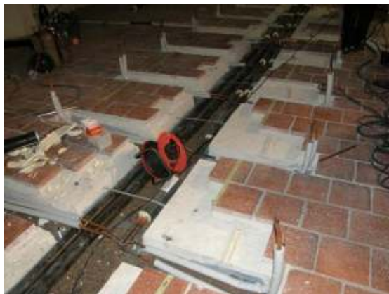
Mittkylverten och rören till bänkvärmen.
