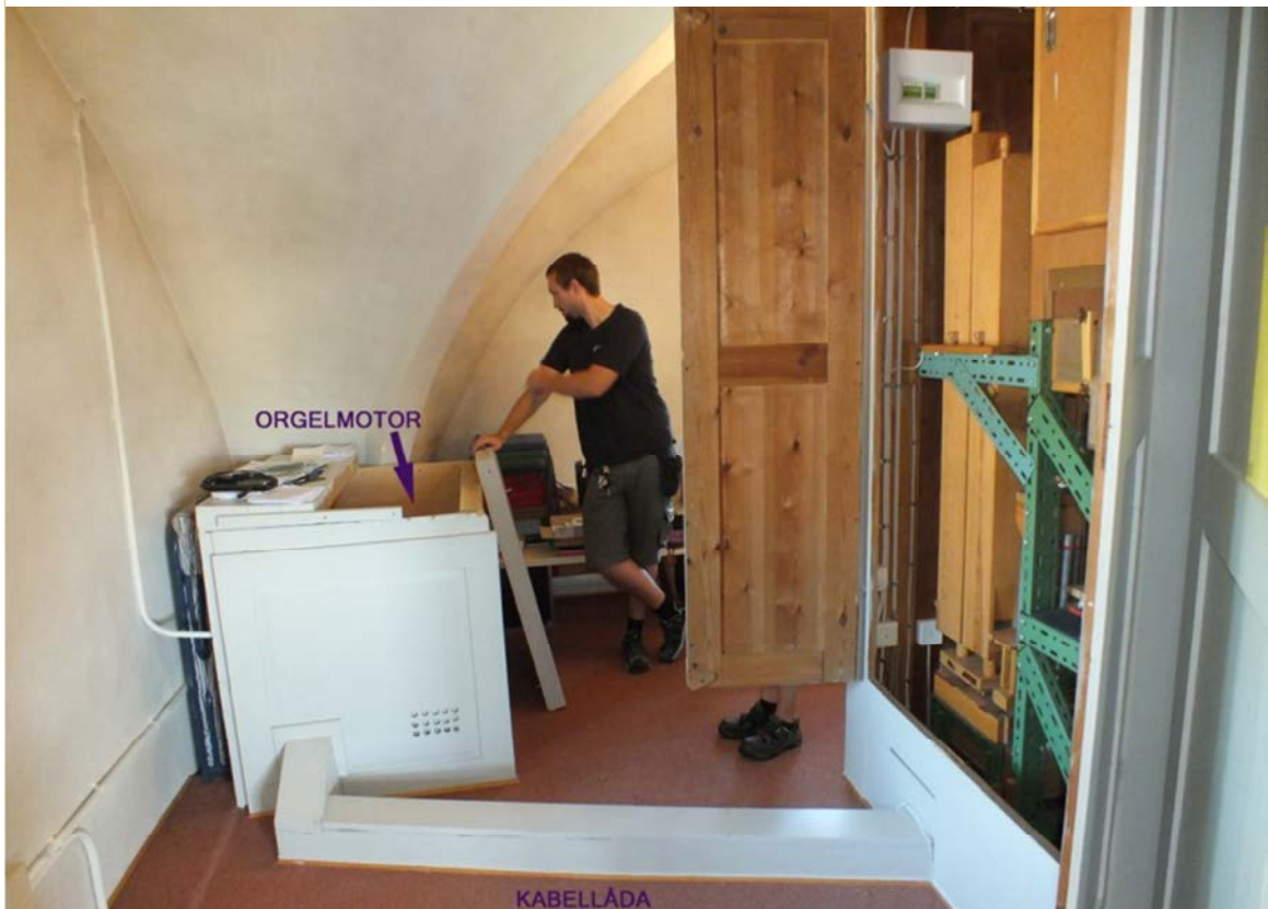
Ledningsdragnings på orgelläktaren går via befintlig kabellåda och genom orgelmotorns låda ned till rökdetektorer i entréhall och på WC.
