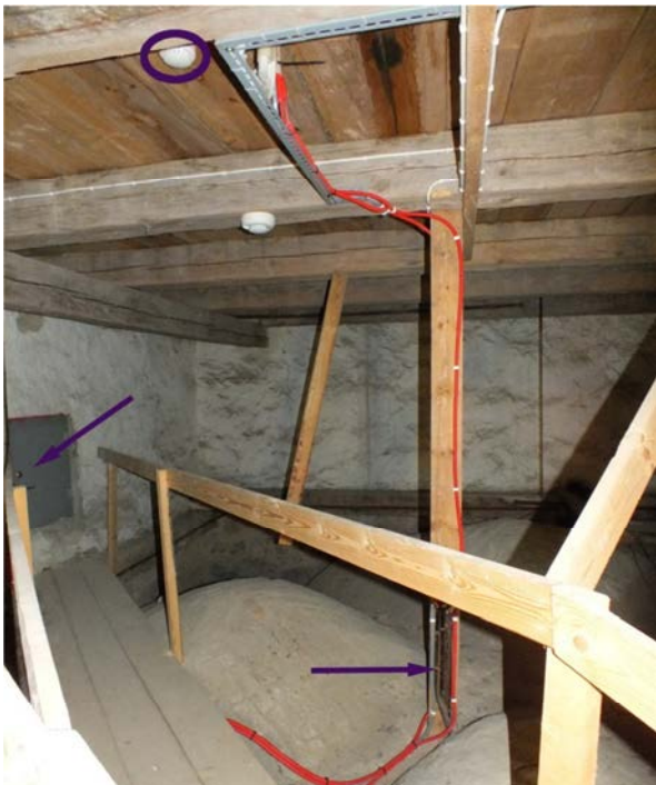
Nedre tornvinden där ledningarna från orgelläktaren går ner. Pilen visar luckan där ledningarna dragits mellan karm och mur. Den runda markeringen visar den nya rökdetektorn, en detektor från det tidigare systemet kan ses på bjälken bakom.
