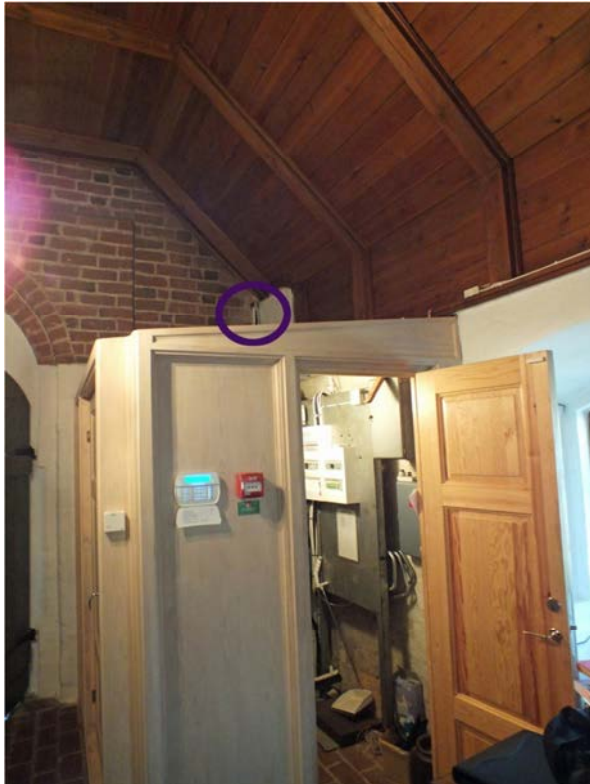
Vapenbuset med sekundärt förrådsutrymme där brandlarmcentralen tillsammans med larmknapp och manöverpanel till inbrottslarmet monterats. Den runda markeringen visar var ledningarna går upp på långhusvinden.
