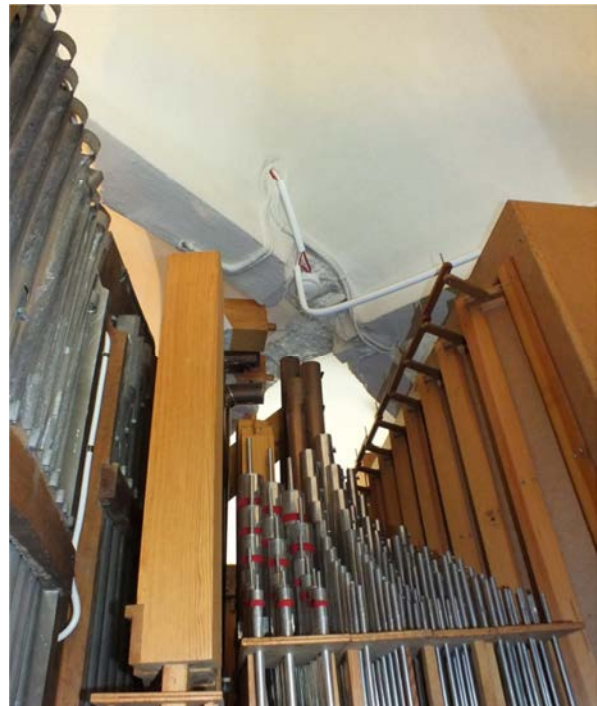
Ledningarna till orgelläktaren kommer ner genom en tidigare håltägning i valvets mitt. En rökdetektor är fäst i valvet och vidare ledningsdragning är gjord ovanpå orgeln med en fästpunkt.
