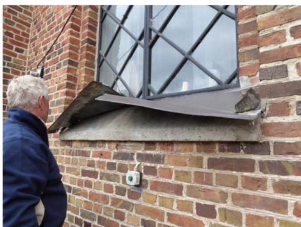
Dåliga solbänksbeslag av plåt.
