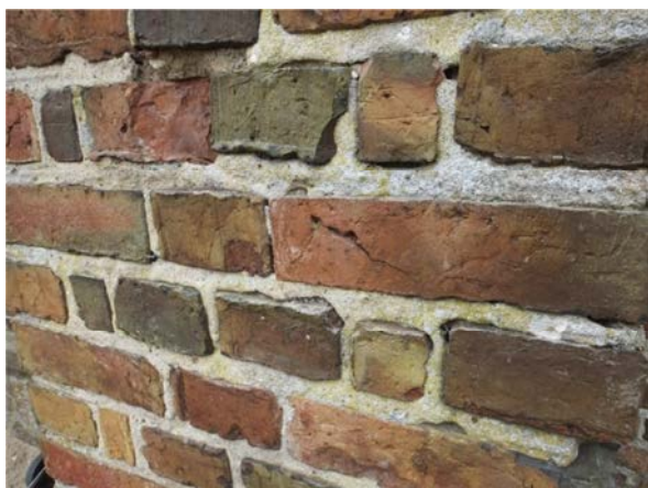
Teglet innan foglagning. Åsfogarna har här helt försvunnit.
