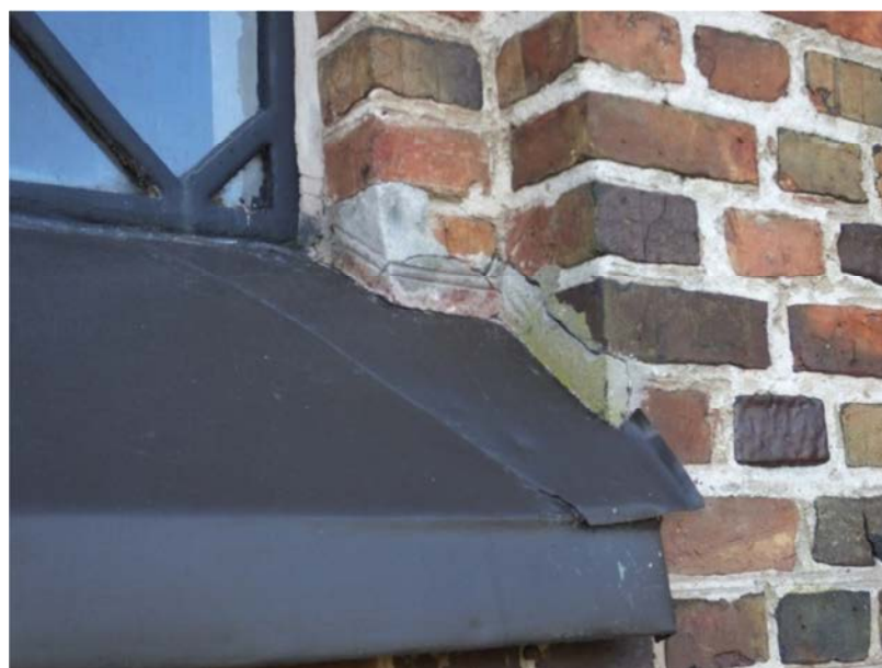
Solbänksbeslagen innan omläggning. Här syns tydligt de dåliga fogarna mellan teglet och plåten samt de hoplappade plåtbitarna.
