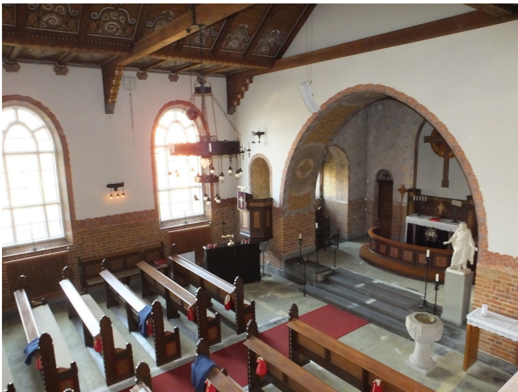
Kyrkan innan renoveringen. Heltäckningsmattan var borttagen och limrester från denna låg som en gulvit matta över stora delar av golvet.
