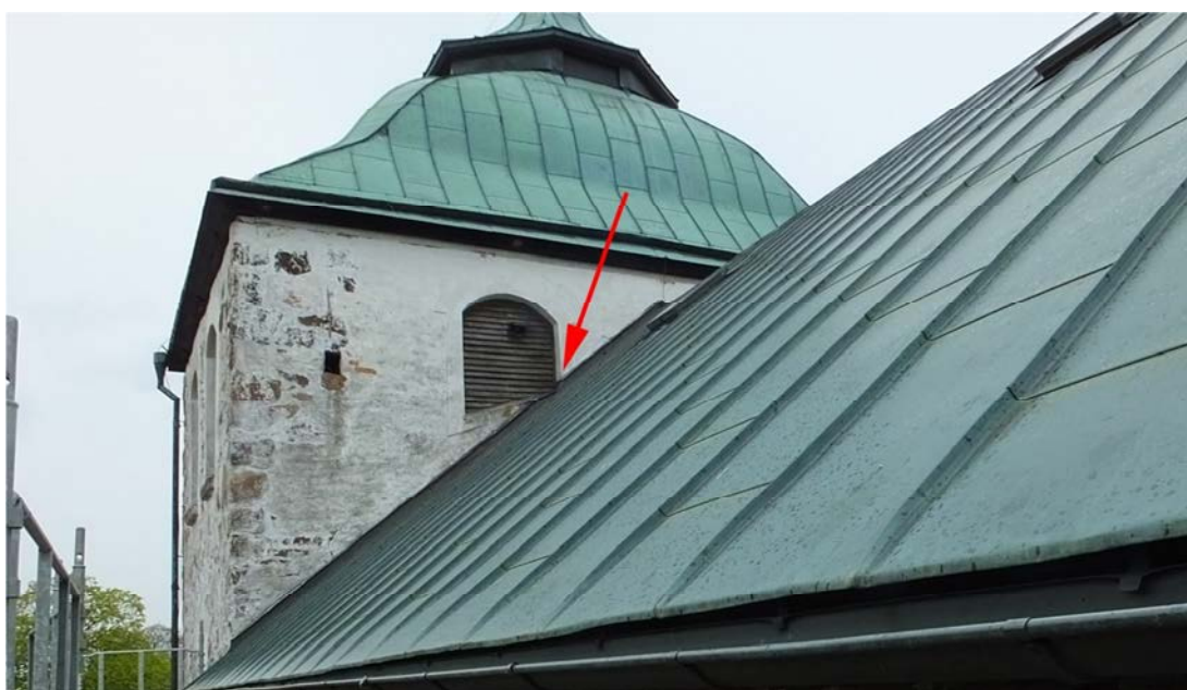
Fig. 8. Pilen utvisar det äldre takets bristfälliga parti mot tornets ljudluckor.
