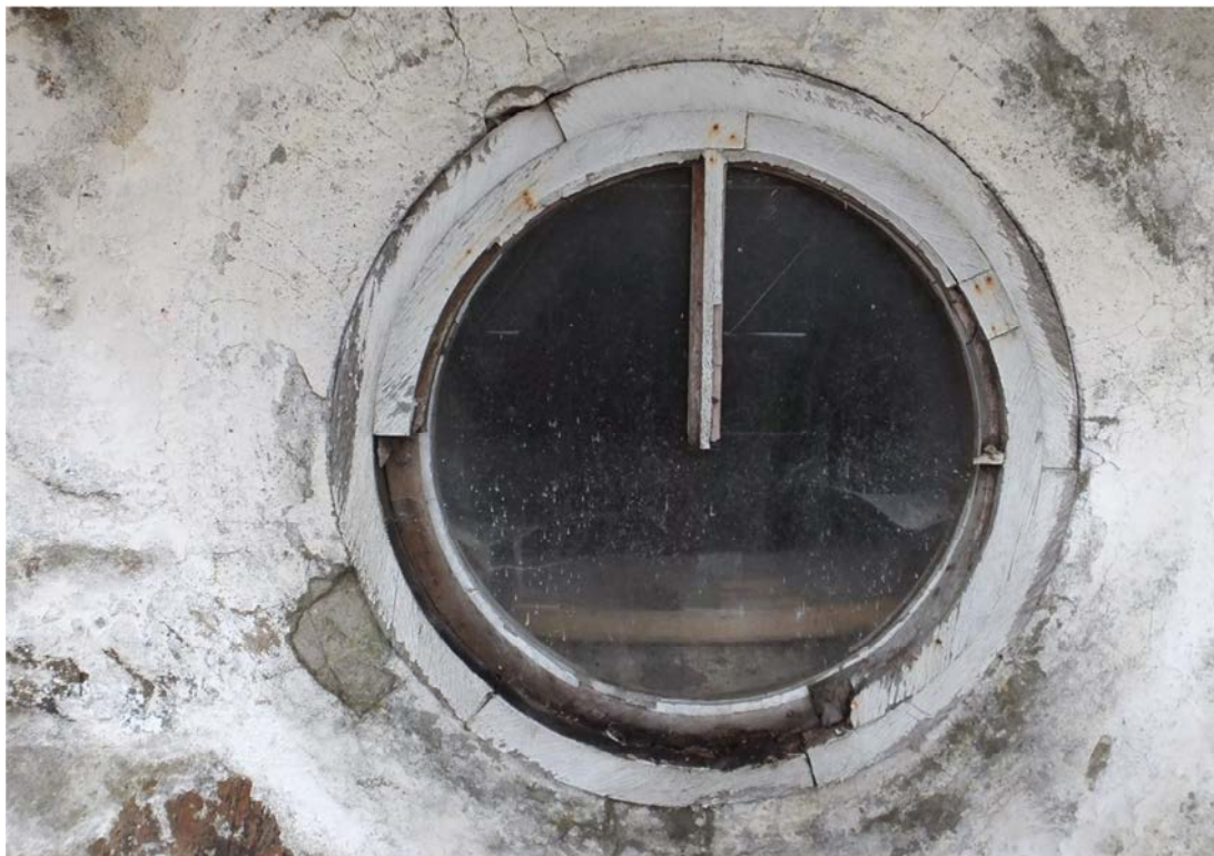
Fig. 4. Det skadade tornfönstret, innan arbetet.
