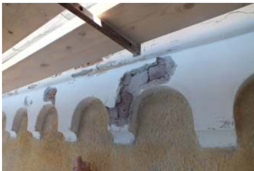
Skadebild på kyrkans gesims. Här syns även en eventuell tidigare anföring på kyrkans gesims.
